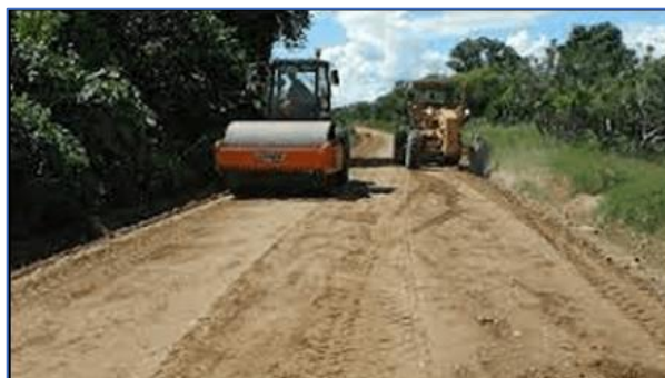
FIGURA 5. Tendido de material y compactación con la aplicación del polímero Megasoil. FUENTE: Elaboración propia.
