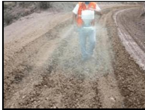
FIGURA 24. Dispersión del polímero Megasoil, aplicándolo directamente en el material tendido in situ.
