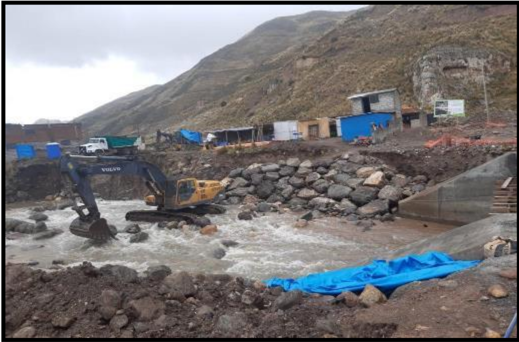
EN LA IMAGEN SE APRECIA A LA MAQUINARIA HACER LOS TRABAJOS DE ENROCADOS
