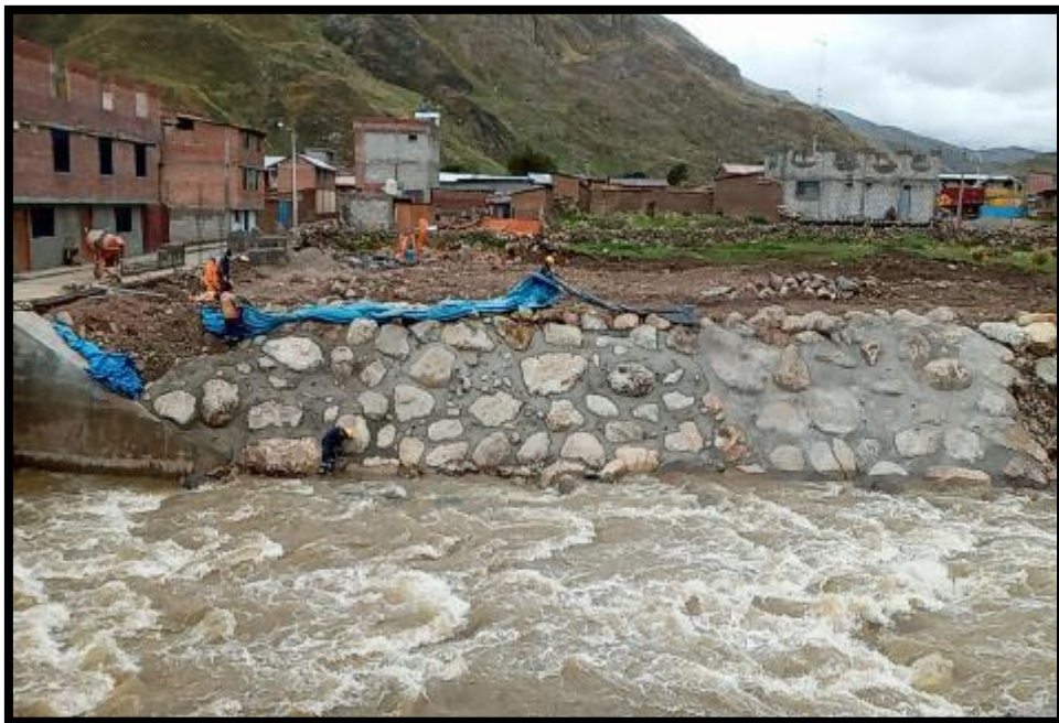
EN LA IMAGEN SE APRECIA EL EMBOQUILLADO DE CONCRETO EN EL ENROCADO
