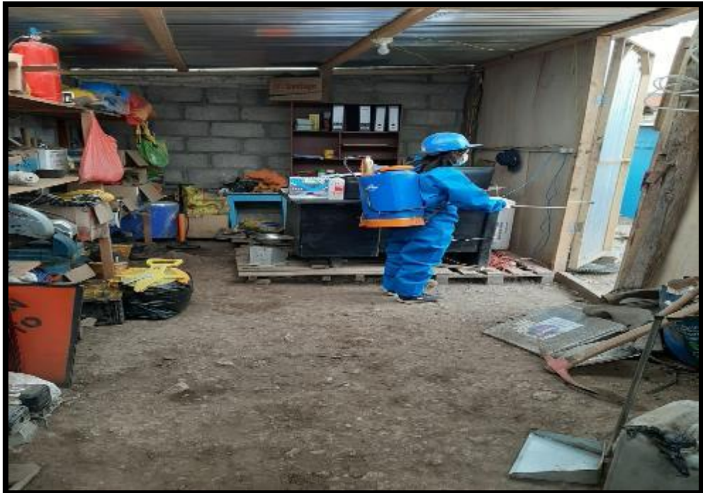
EN LA IMAGEN SE APRECIA LA DESINFECCION DE LOS AMBIENTES EN OBRA
