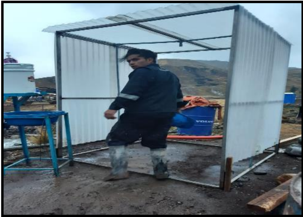
EN LA IMAGEN SE APRECIA EL USO DE LA CABINA DE DESINFECCION EN OBRA
