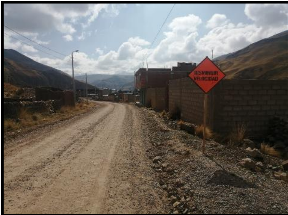
EN LA IMAGEN SE APRECIA LA SEÑALIZACION TEMPORAL EN OBRA EN LA CALLE HUANUCO
