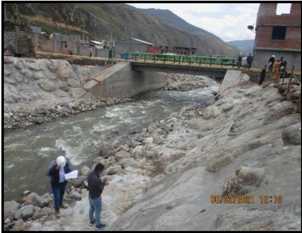
EN LA IMAGEN SE APRECIA LA VERIFICACION DE DISTANCIAS EN EL ENROCADO
