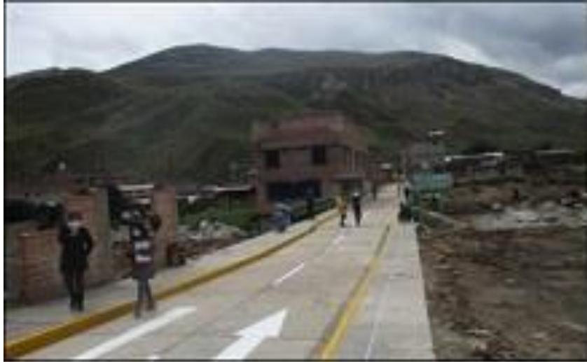
Figura 60. Pintura en sardinel, Calle Libertad
