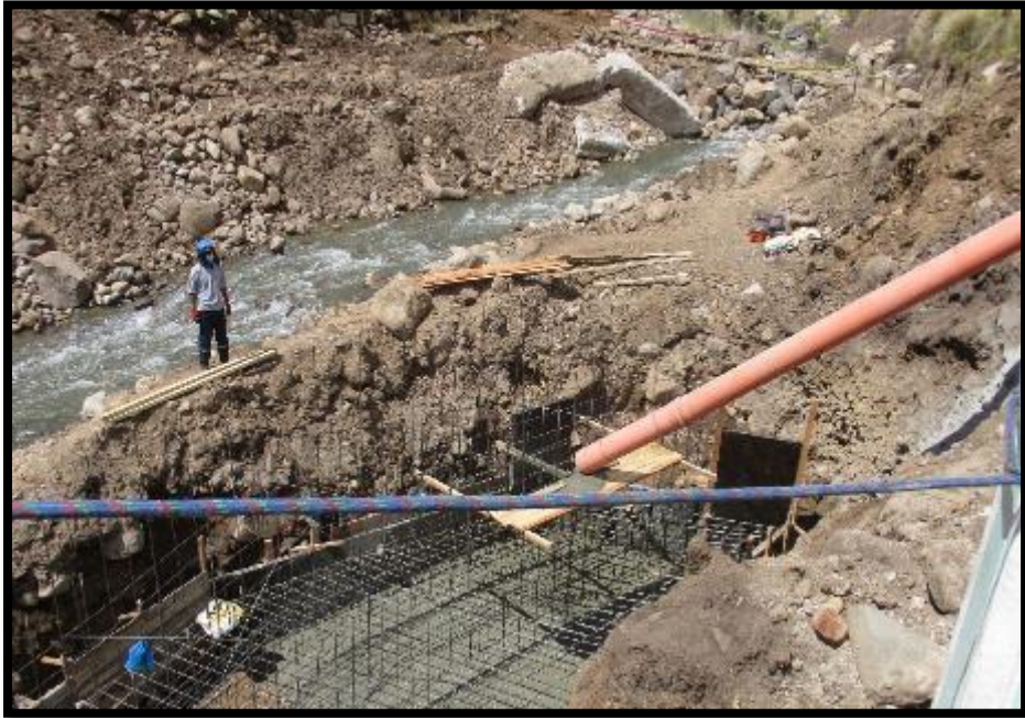
EN LA IMAGEN SE APRECIA EL VACIADO DE CONCRETO PARA ZAPATA Y ALEROS
