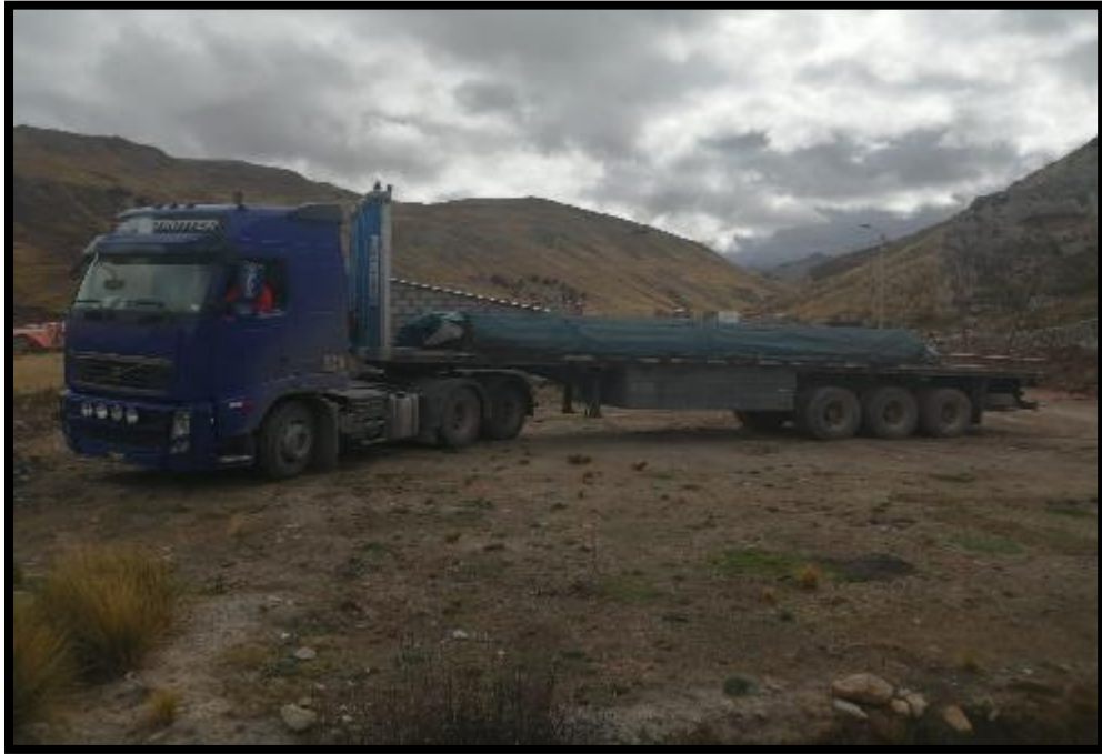
EN LA IMAGEN SE APRECIA LA LLEGADA DEL ACERO PARA LOS TRABAJOS EN OBRA
