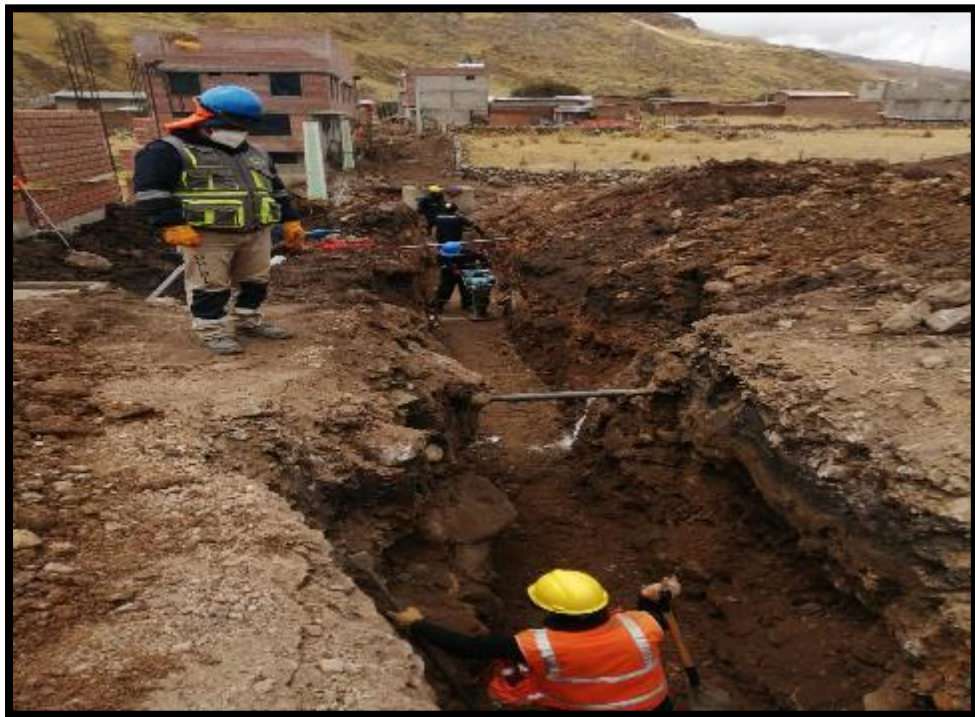
EN LA IMAGEN SE APRECIA EL RELLENO Y COMPACTADO EN LA ZANJA DE TUBERIA PARA DESAGUE
