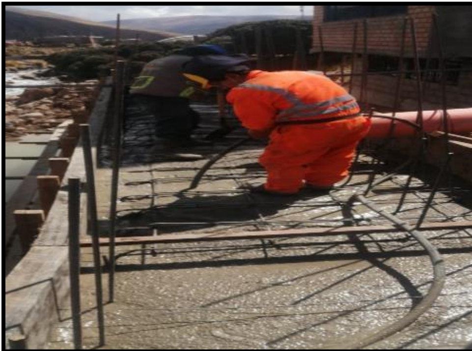
EN LA IMAGEN SE APRECIA EL VACIADO DE CONCRETO EN LA CAJUELA DEL PUEBLO
