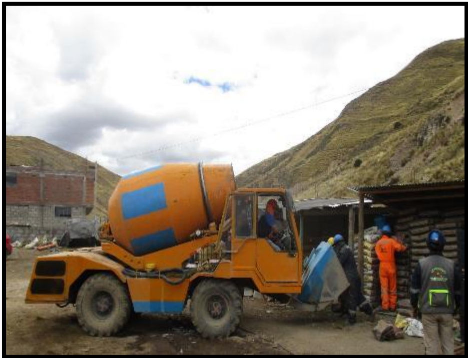
EN LA IMAGEN SE APRECIA LA PREPARACION DEL CONCRETO EN CARMIX PARA LOS ESTRIBOS Y ALEROS DEL PUEBTE
