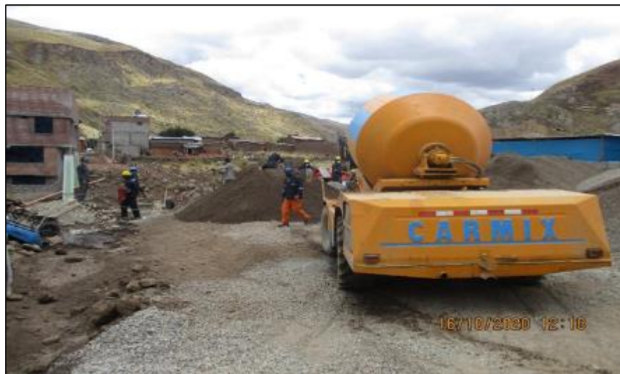
Figura 36. Concreto para la cajuela del estribo
