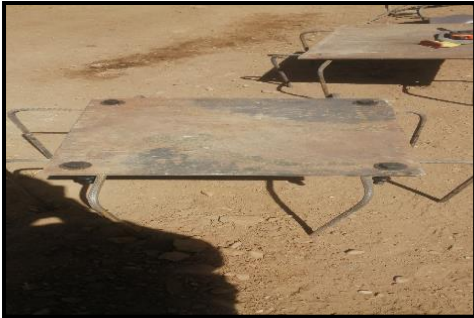
EN LA IMAGEN SE APRECIA LA HABILITACION DE LOS APOYOS FIJO Y MOVIL PARA EL PUENTE
