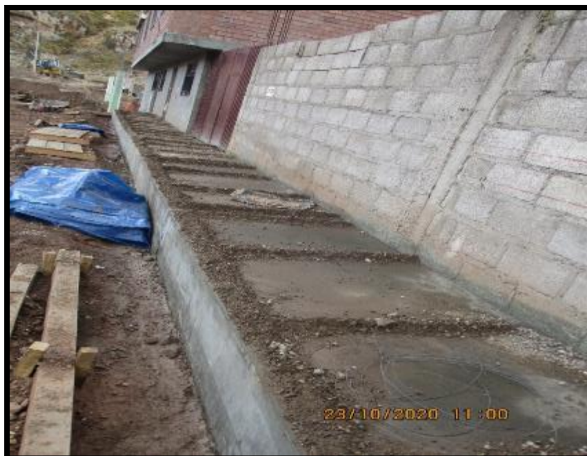
EN LA IMAGEN SE APRECIA EL CURADO DE CONCRETO CON ARROCERAS EN VEREDAS
