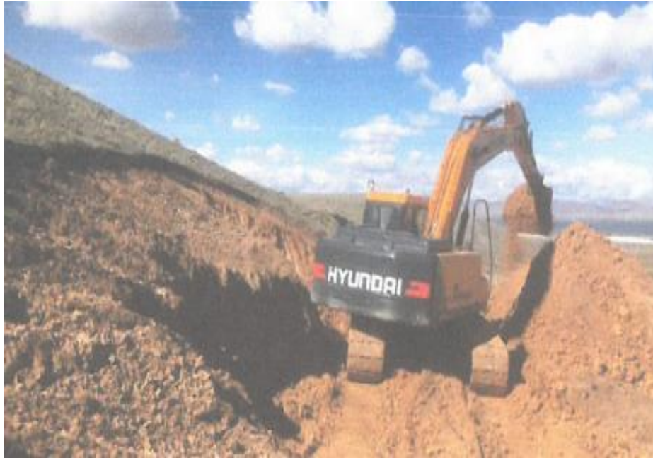
Fotografía 03: En la imagen se visualiza el proceso de inspección de la cantera C (arcilla) en la Progresiva 1+254, sector Inca Pirca.
