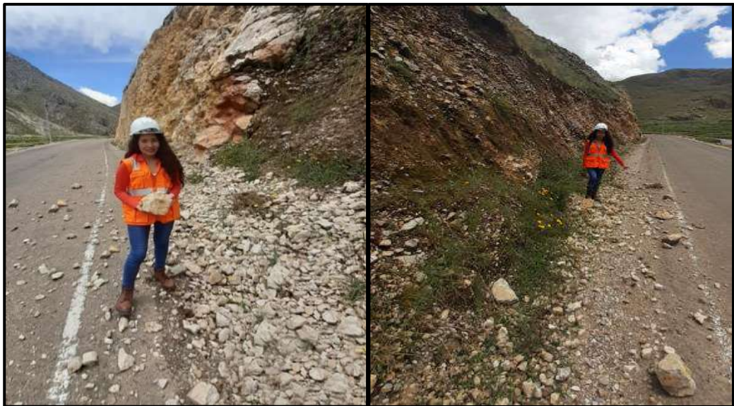
Figura 01. Caída de rocas en la progresiva 018+632.14 Fuente: Elaboración propia.
