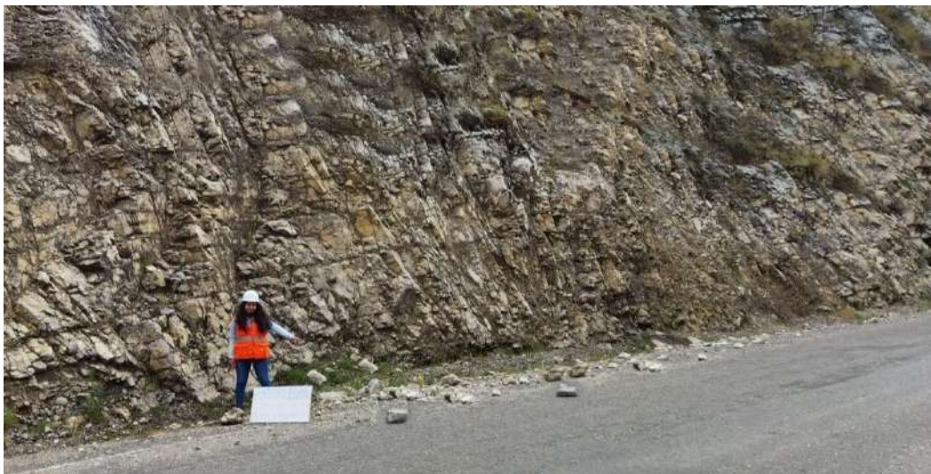
Figura 02. Caída de rocas en progresiva 018+723 Fuente: Elaboración propia.
