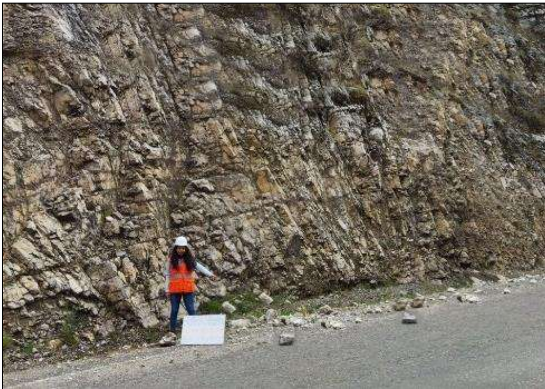
PANEL FOTOGRÁFICO OCTUBRE 2021 FOTOGRAFÍA 04 Caída de rocas en la Carretera puente Collpa – Yanacancha, en la progresiva del Kilómetro 018+720.
