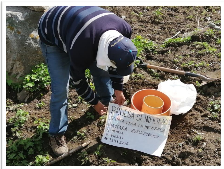
FOTOGRAFIA N° 11.- VISTA FOTOGRAFICA DE LA REALIZACION DE LA CALICATA PARA TOMA DE MUESTRAS
