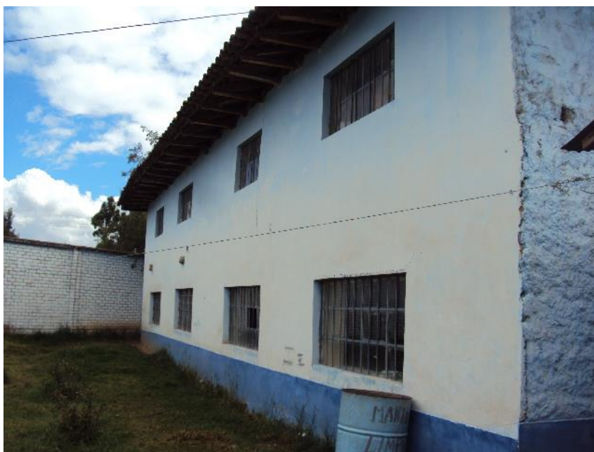
Infraestructura actual del área administrativa (construcción rústica de aproximadamente 40 años de antigüedad)
