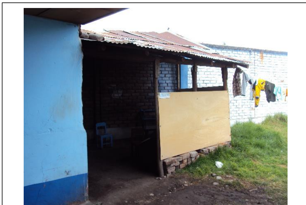
Detalles de la situación actual del área acondicionado para el funcionamiento de la cocina (cocina a leña)
