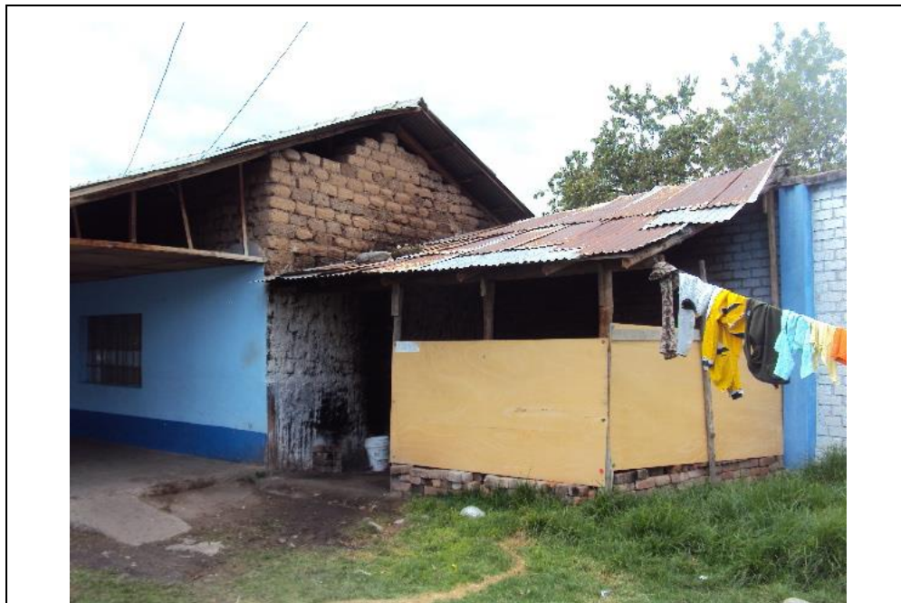
Situación actual del área acondicionado para el funcionamiento de la cocina (cocina a leña)
