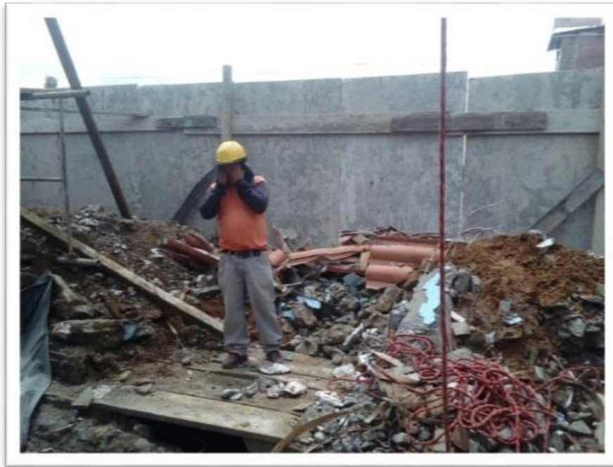
Figura 12- Desperdicios generados en obra.
