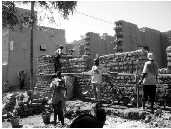
Figura 5: Construcción de la escuela en Mopti (Malí) mediante adobes de barro de gran formato.
