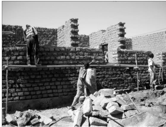
Figura 6: El edificio construido mediante esta técnica tradicional adquiere una gran inercia térmica como respuesta al calor extremo de la región. El uso de técnicas tradicionales permite la asimilación del proyecto por parte de la población local, al tiempo que le ayuda a recuperar su autoestima y el orgullo su cultura tradicional.
