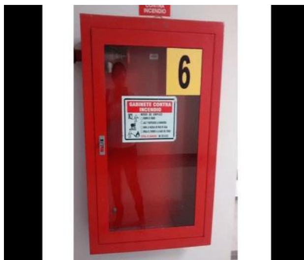
Figura 6. Gabinete contra incendio.
