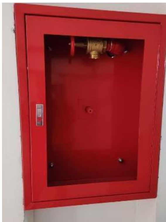
Figura 70. Limpieza del interior del gabinete.
