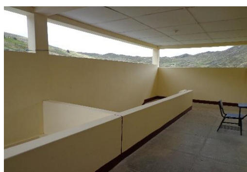
Muros y paredes deterioradas
