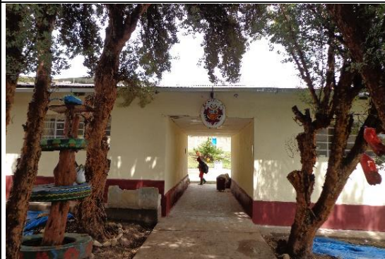
Aulas de material rustico deteriorados
