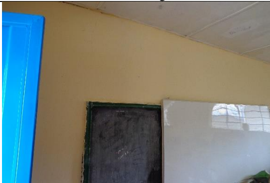
Inexistencia de equipos y sistema eléctrico.
