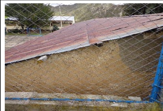
Techos deteriorados con filtraciones
