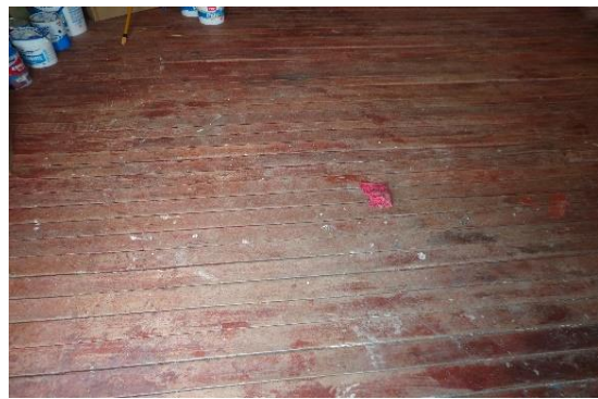
Pisos deteriorados en aulas
