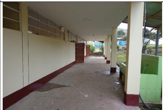
Filtraciones en aulas
