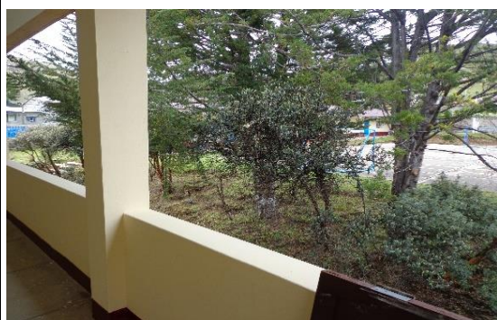
Inexistencia de gárgolas para drenaje pluvial
