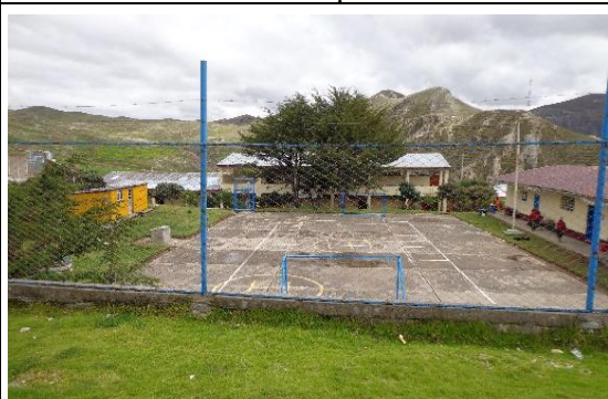
Cerco de malla olímpica deteriorado
