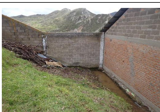
Desniveles de cerco perimétrico dañados
