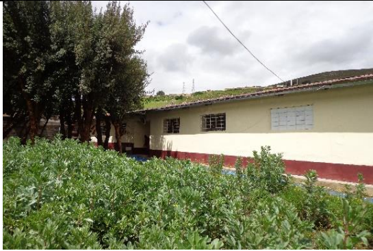
Aulas inadecuadas de adobe
