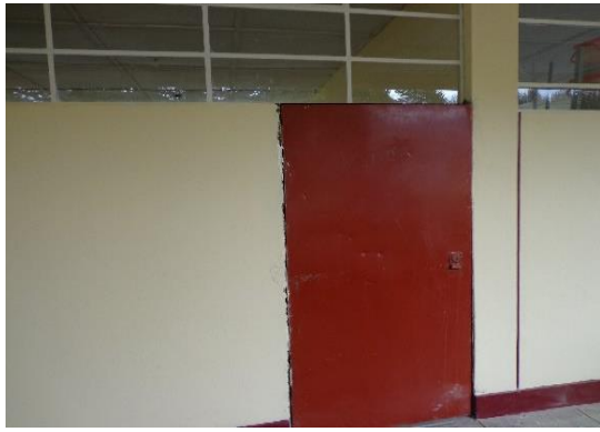
Puertas metálicas inseguras en aulas
