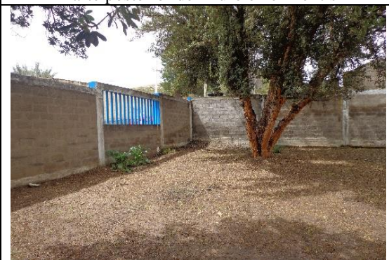
Grietas y fisuras en cerco perimétrico
