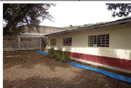
Aulas de material rustico deteriorados
