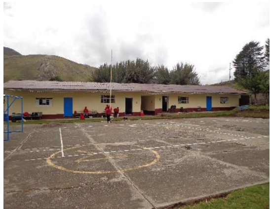
Losa deportiva deteriorada
