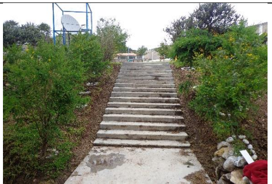
Accesos sin barandas y con grietas
