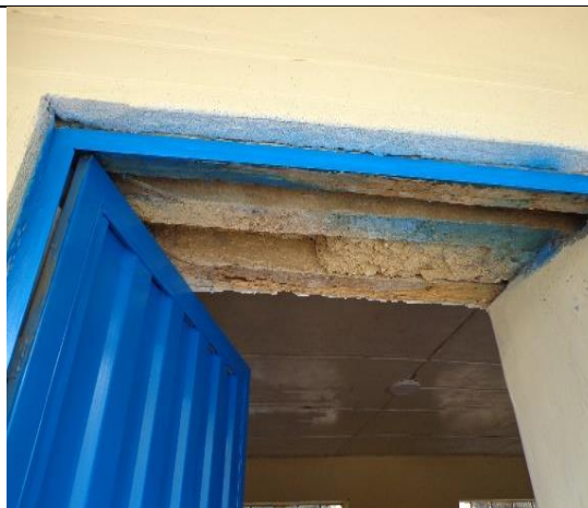
Inadecuadas condiciones en aulas
