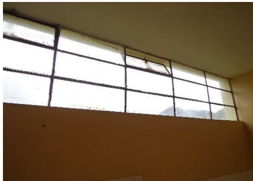
Ventanas inadecuadas y opacas.
