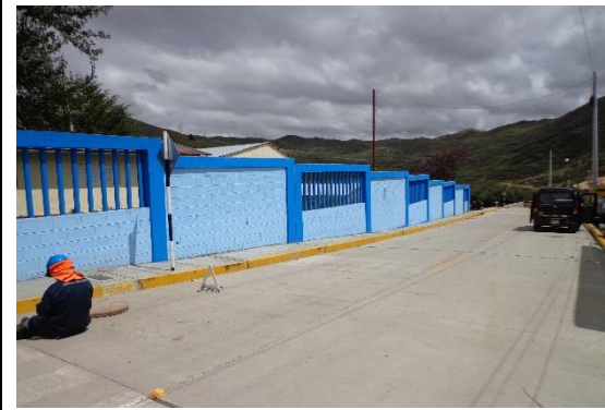
Frontis de la I.E. con presencia de fisuras
