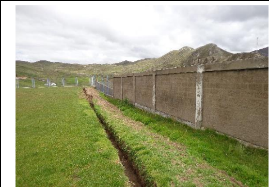
Grietas y fisuras en cerco perimétrico
