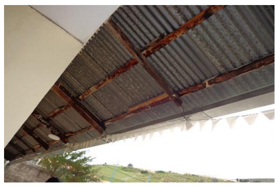
Canaleta de drenaje pluvial deterioradas
