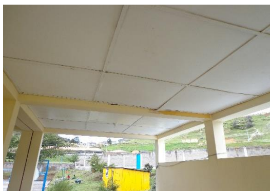
Cielos rasos con filtraciones
