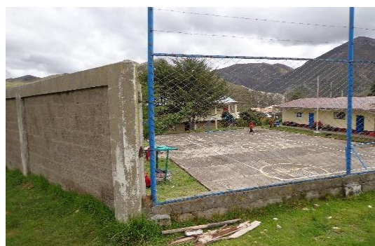
Cerco de malla olímpica deteriorado
