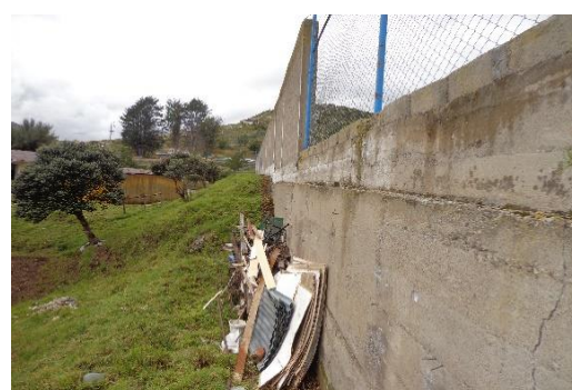
Fisuras en muro de contención
