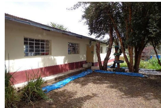
Aulas de material rustico deteriorados
