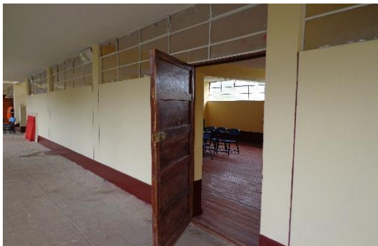
Vidrios faltantes e inadecuados
