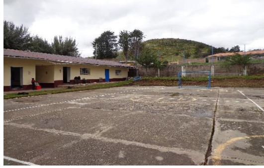
Inadecuadas condiciones para los deportes
