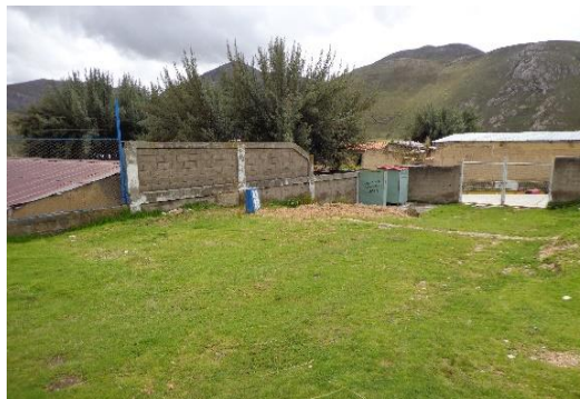
Cerco perimétrico dañado
