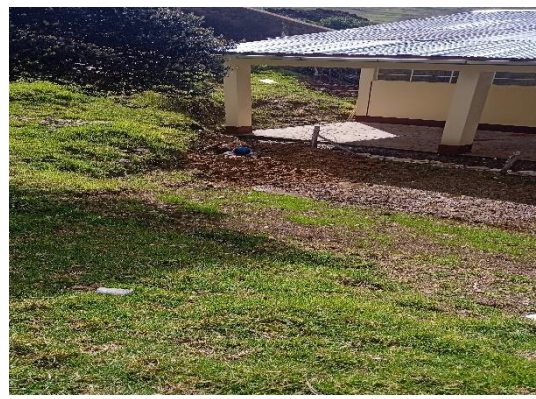
Inexistencia de drenaje pluvial adecuado
