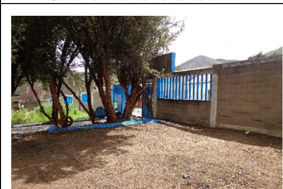
Grietas y fisuras en cerco perimétrico
