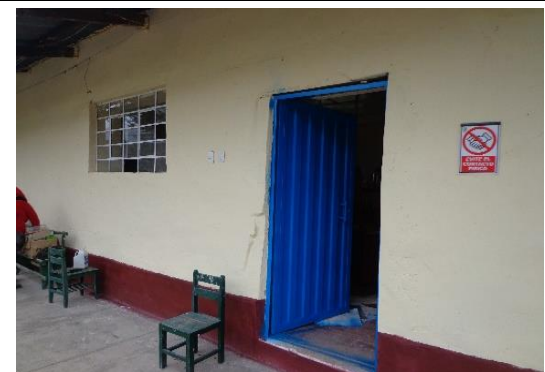
Paredes deterioradas, puertas descuadradas
