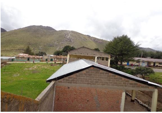
Techos con inadecuados drenajes pluviales
