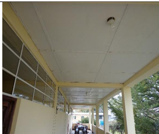
Cielos rasos deteriorados
