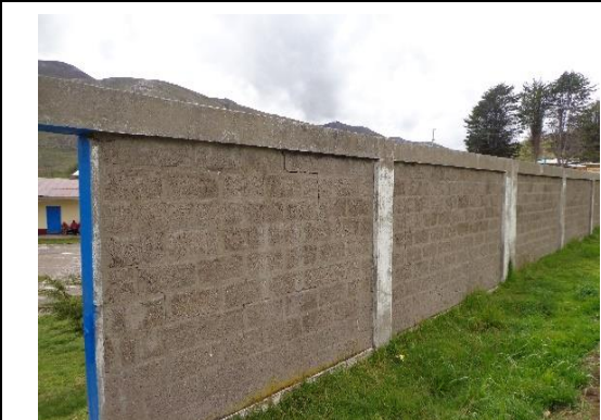
Grietas y fisuras en cerco perimétrico
