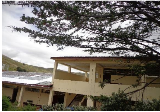
Inexistencia de drenaje pluvial
