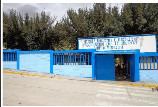
Puerta de ingreso de la I.E. presenta grietas
