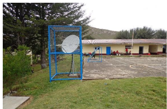
Equipo de comunicaciones mal ubicado
