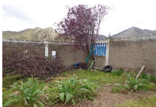
Paredes fisuradas en cerco perimétrico
