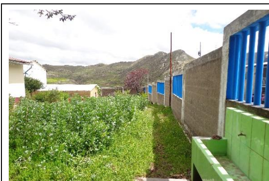
Lavaderos en puerta de ingreso averiados
