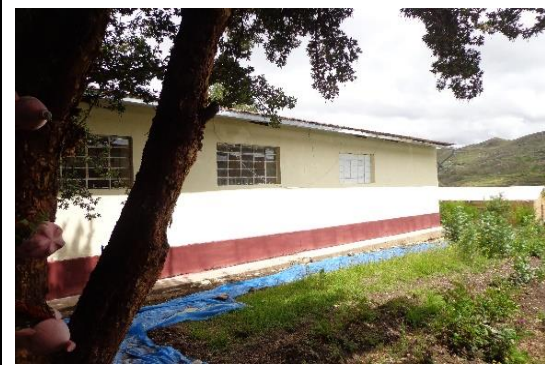
Aulas de material rustico deteriorados
