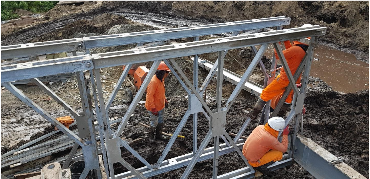
Fotografía 5. Instalación y montaje de las estructuras del puente modular mediante el uso de una excavadora para el izaje de las estructuras de gran peso
