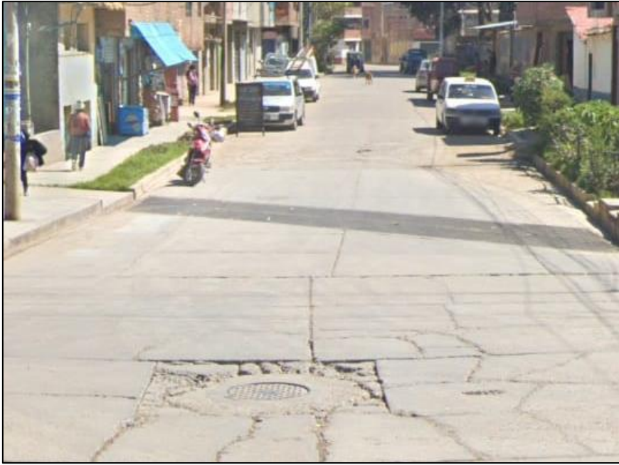
Figura 5-2. Estado del pavimento junto a la rejilla de alcantarillado y tapa de buzón. Fuente: Elaboración propia
