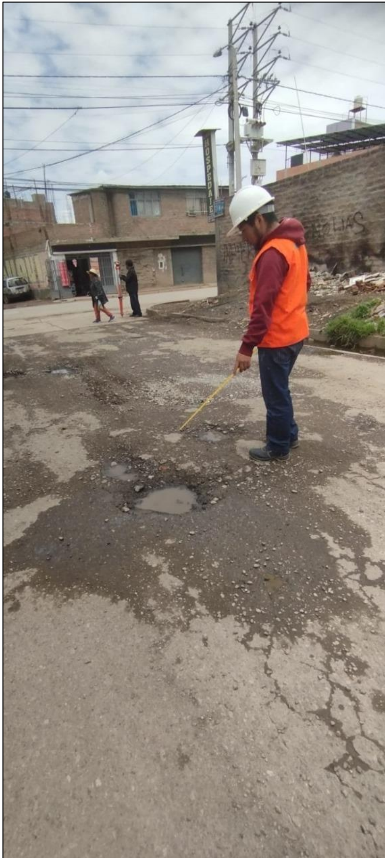
Fotografía 6 Medición de falla estructural del pavimento, hueco con un nivel medio
