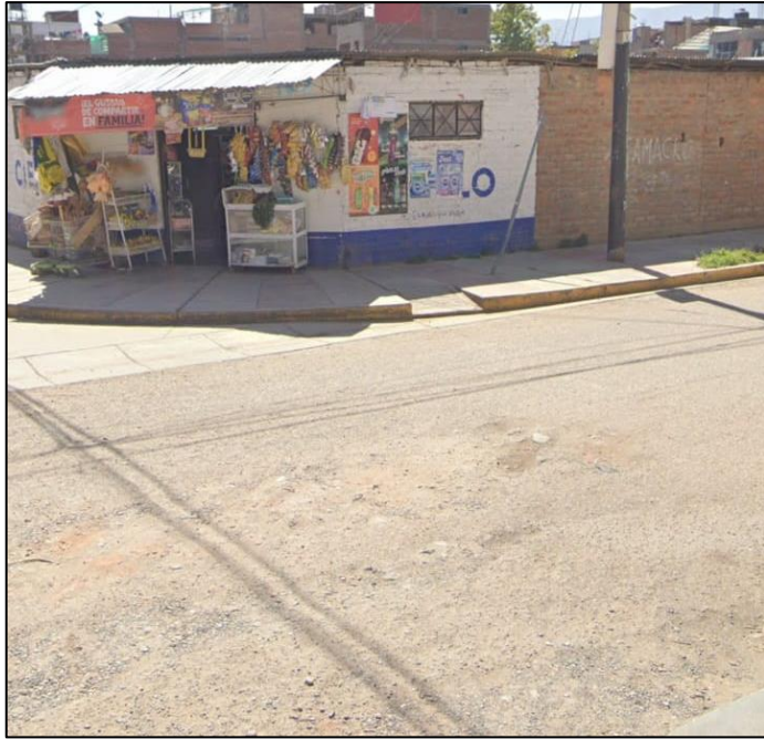
Figura 5-6. Desintegración y disgregación Desintegración y disgregación
