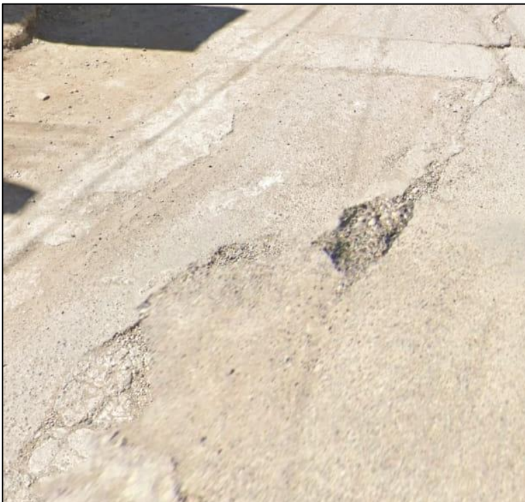
Figura 5-4. Huecos en el pavimento flexible. Fuente: Elaboración propia.
