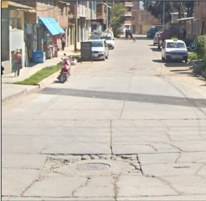
Figura 5-5. Grietas de fatiga Fuente: Elaboración Propia
