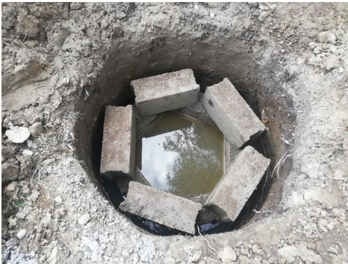
Fotografía 8. Vista del pozo de absorción 3 con ladrillos King Kong.
