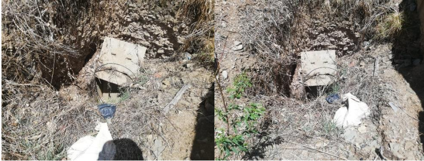
Fotografía 14. Vista del pozo de percolación sin mantenimiento y no cumple su función.
