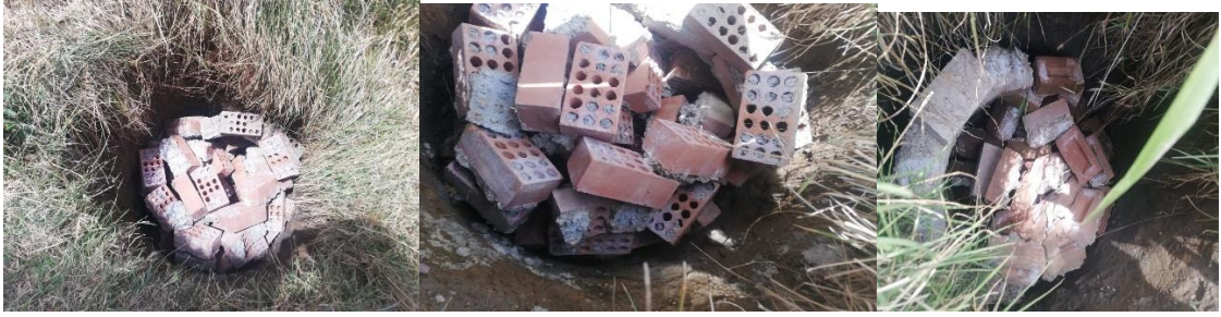
Fotografía 13. Vista de la condición del pozo de percolación destruida.
