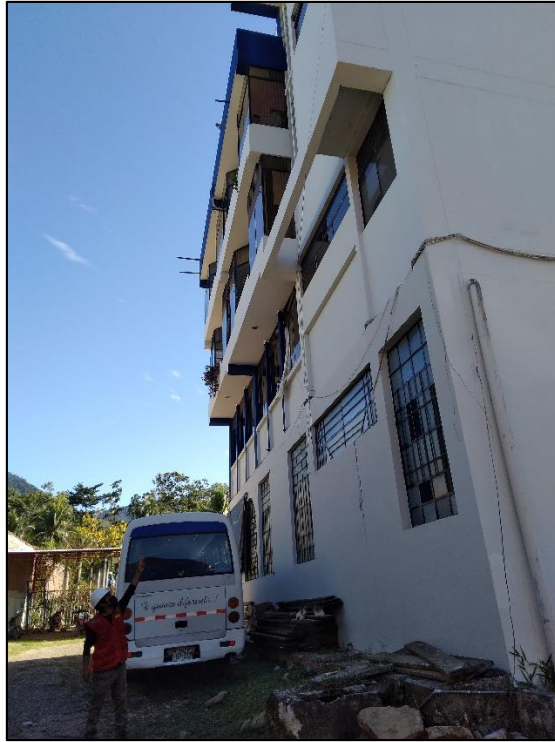
Fotografía N° 3. Identificación de irregularidades en elevación del Palacio Municipal de Rio Negro
