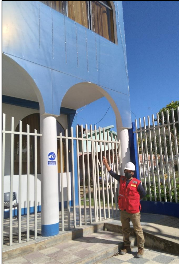
Fotografía N° 7. Las columnas pueden generar una un piso blando en la edificación.
