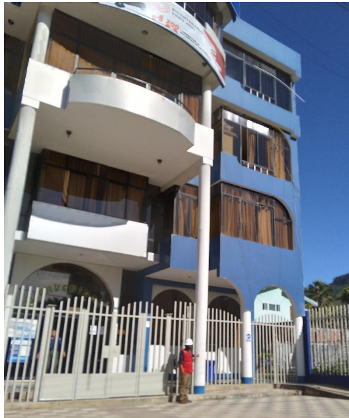
Fotografía N° 6. Las columnas del frontis de la edificación quedan por fuera de las rejas, además se muestra una particular estructura en el frontis y las columnas circulares son esbeltas y constan de dos pisos poniéndolo en riesgo.
