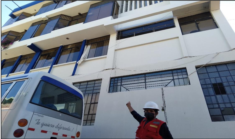
Fotografía N° 5. Identificación de elementos estructurales vulnerables
