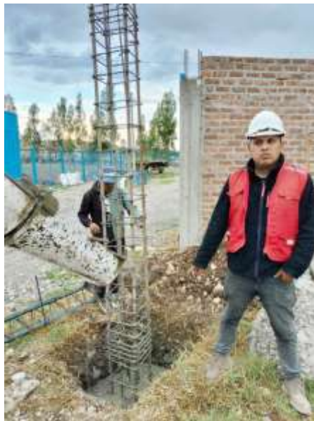
Imagen 10: Vista general del proceso de vertido de concreto en la zapata de la columna C-12.
