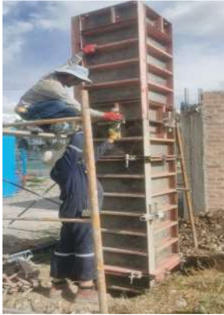
Imagen 03: Proceso de encofrado de las columnas de sección cuadrada de 50 cm x 50 cm.
