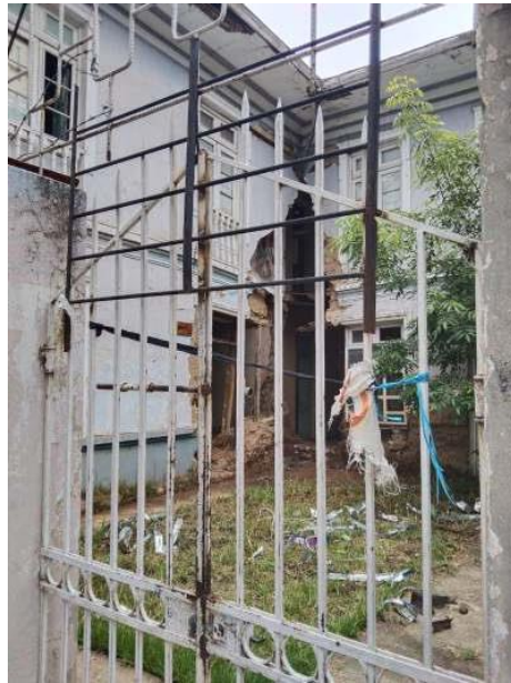
FOTO N°6: Foto de detalle del de la fachada interna-derrumbada Fuente: Elaboración propia
