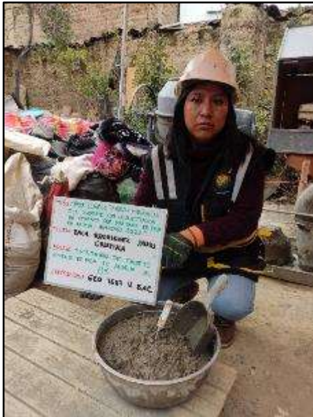
Fotografía N° 58: Toma de temperatura del concreto recién sacado de la mezcladora con 8% de paja de arveja
