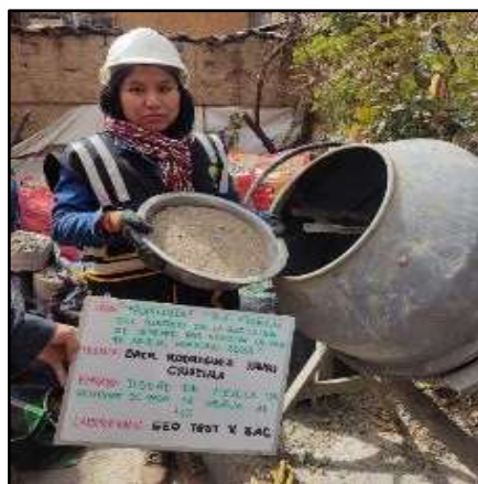
Fotografía N° 31: Incorporación de arena fina para la mezcla del concreto con 4% de paja de arveja
