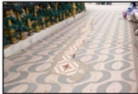
Pésimo estado de pisos
