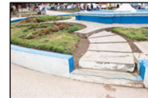
Mal estado de estructuras de movimiento
