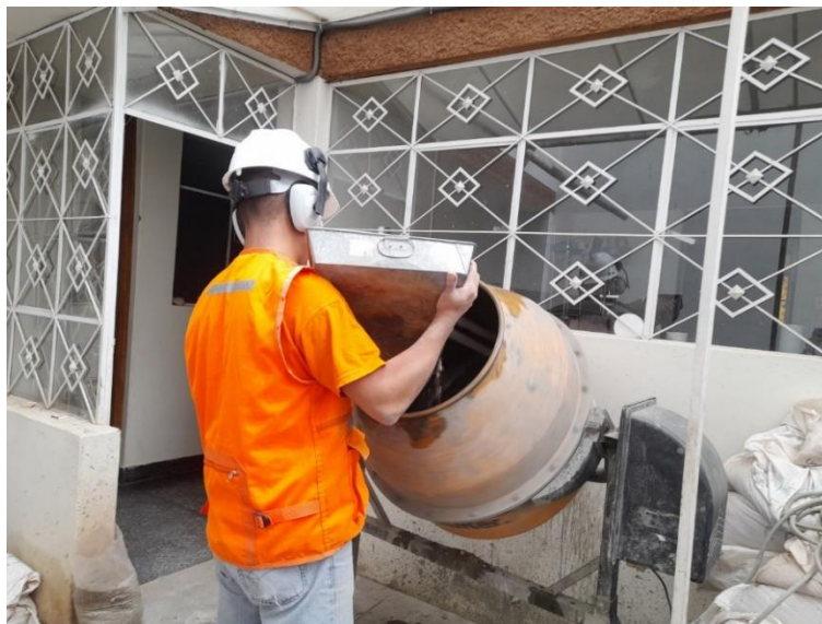
Figura 3.34. Adición del agregado grueso y fino durante la preparación de la mezcla de concreto.
