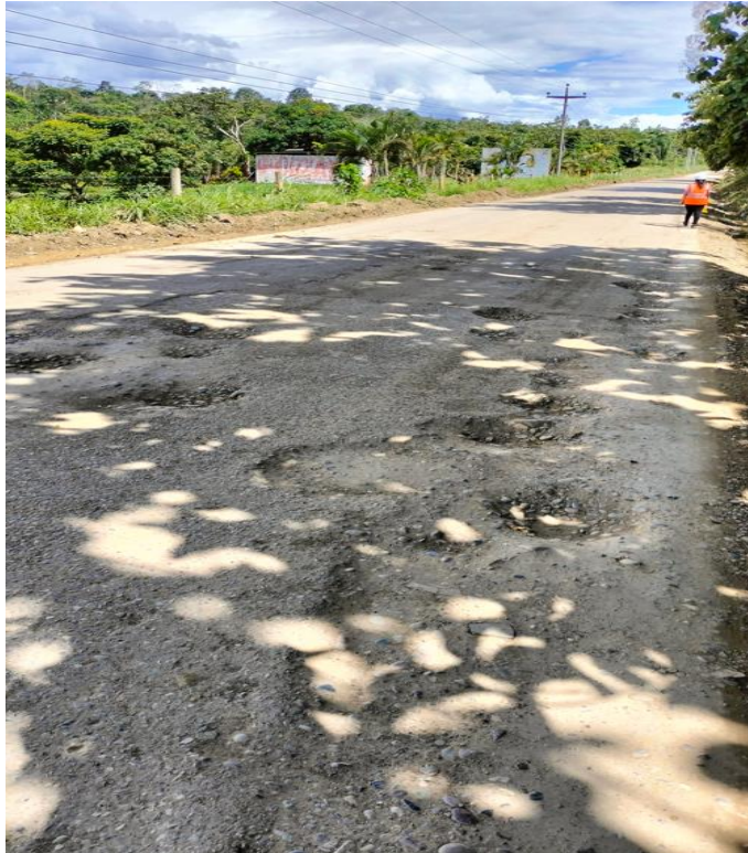
Fotografía N°02: Vista general del tramo más afectado.
