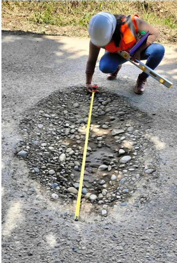
Fotografía N°04: Inspección de las fallas, mediante método VIZIR tradicional.
