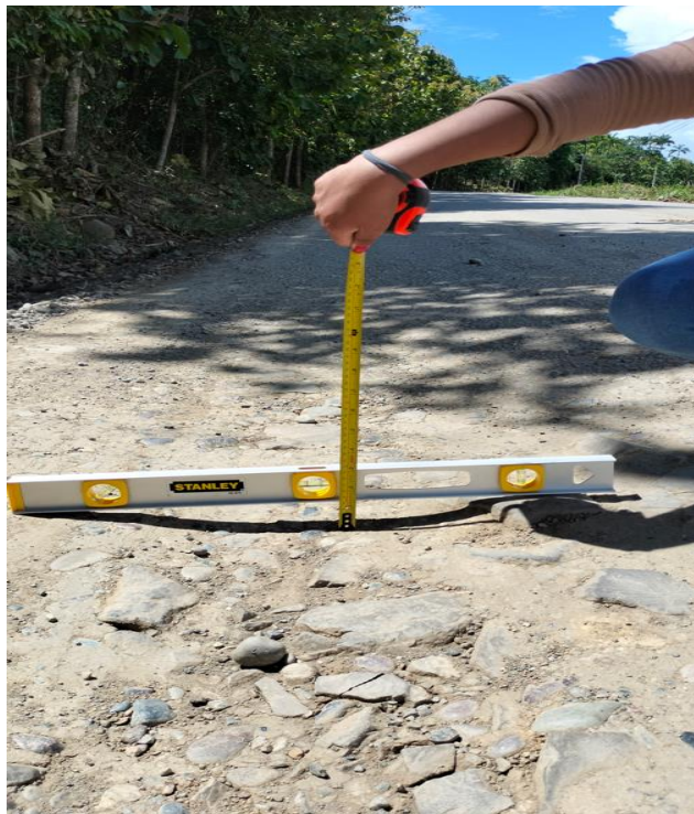
Fotografía N°05: Identificación y medición de fallas
