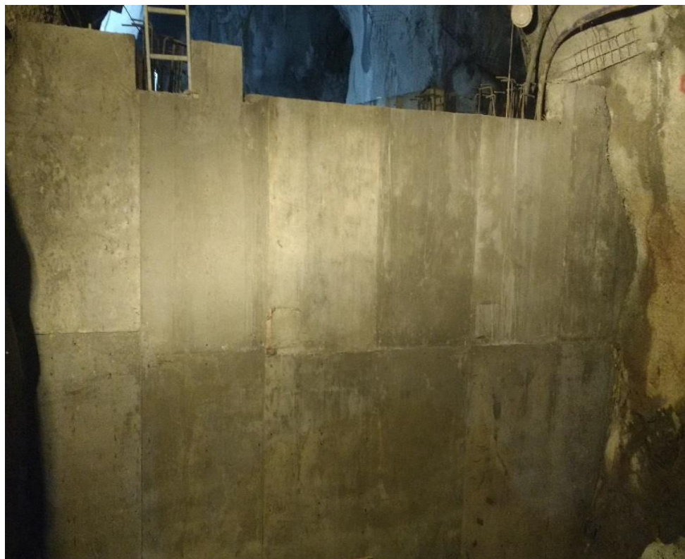
Fotografía N° 10: Traslado de concreto para el muro n° 01 de la cámara de bomba nv 100
