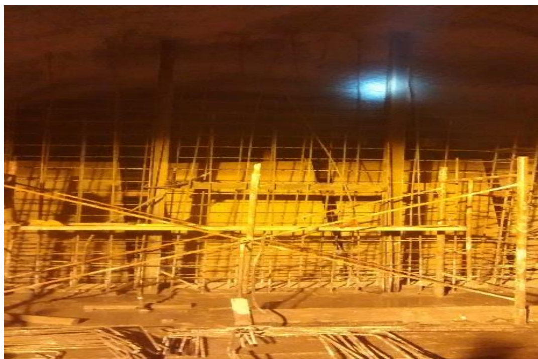
Fotografía N° 4: Colocación de acero de refuerzo para muro n° 01 cámara de bomba nv 100
