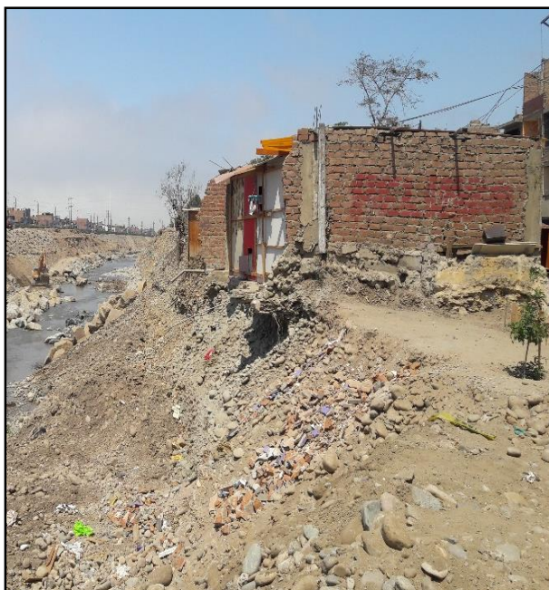
Fotografía N° 3.- Se observa el peligro de deslizamiento, y vivienda en estado de riesgos de colapso.
