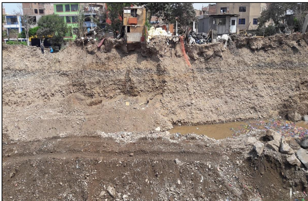
Fotografía N° 9- Se observa el talud de la margen derecha del río Rímac, donde hay un gran grado de inestabilidad.
