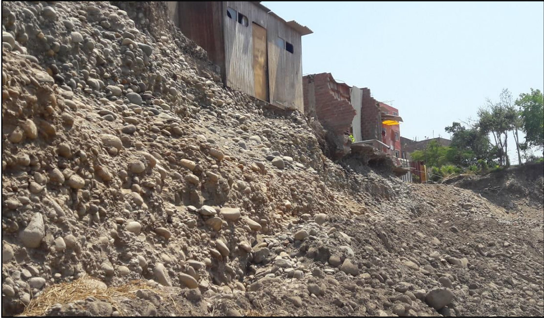
Fotografía N° 1.- Se observa las viviendas afectadas por el fenómeno del Niño Costero.
