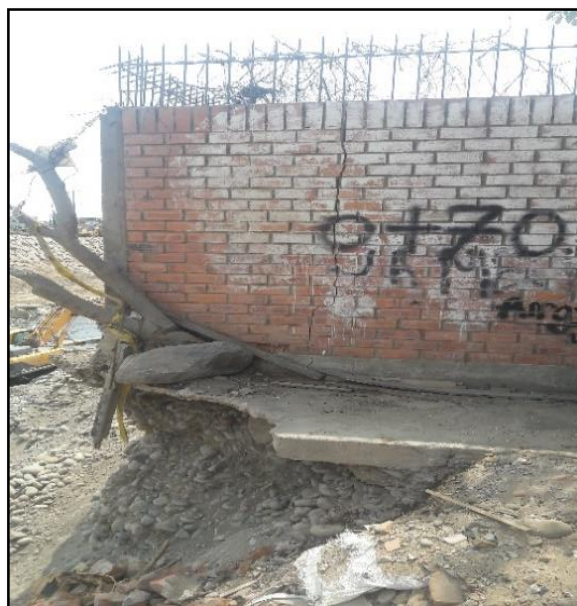
Fotografía N° 7- Se observa rajadura por el peligro de deslizamientos.
