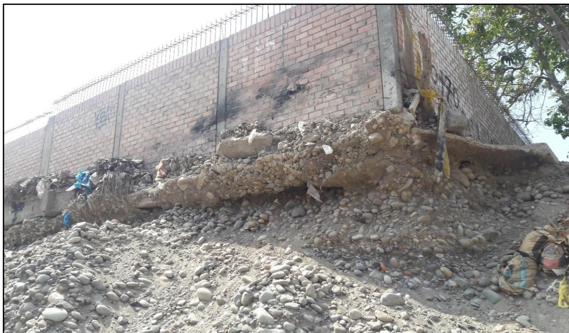
Fotografía N° 5- Se observa colapso del centro educativo inicial
