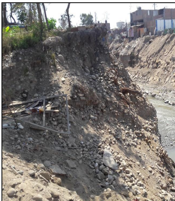
Fotografía N° 4- Se observa la inestabilidad de Talud de la margen derecha del río Rímac.
