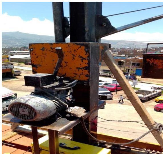
Figura 18. Estado de maquinas
