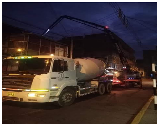
Figura 27. Señales de seguridad ausentes.
