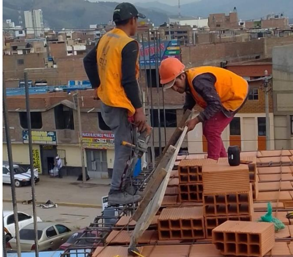
Figura 22. Trabajos en altura sin seguridad fija.
