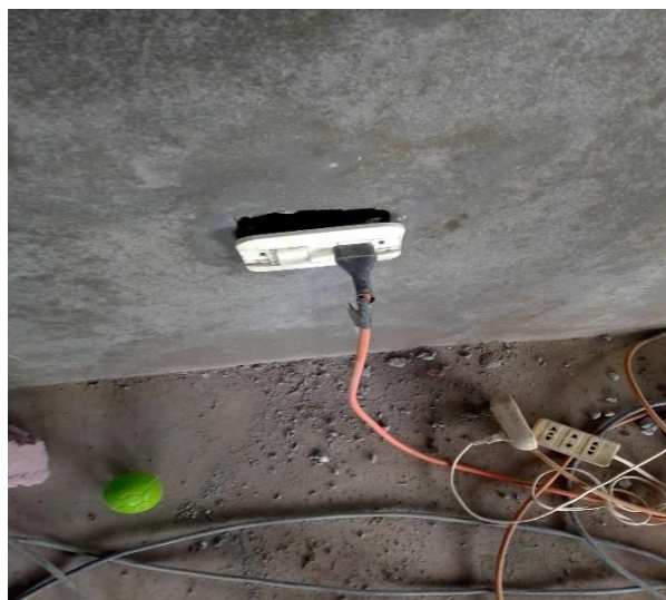
Figura 30. Conexiones expuestas a la intemperie
