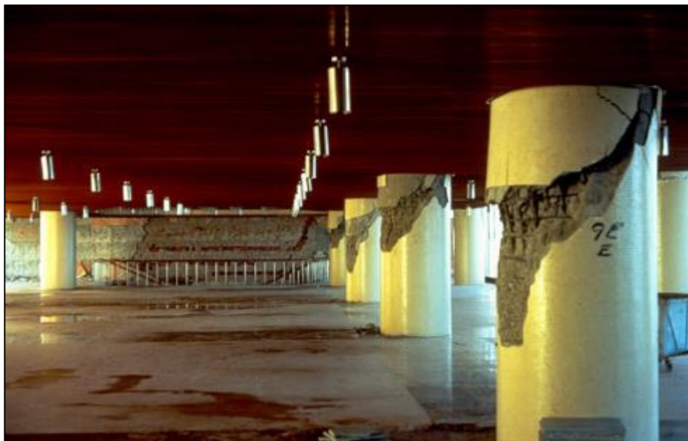
Figura 2 : Colapso De Edificio Comercial, Ciudad De Pisco 2007 Fuente: Archivo Instituto Geofísico del Perú.
