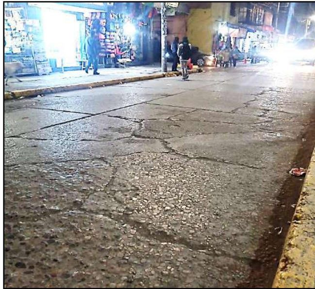
Figura 1.2 Falla en pavimento rígido
