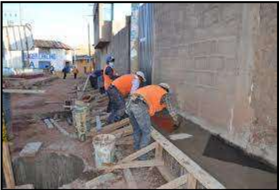
Imagen N° 02: en la imagen se visualiza el trabajo de encofrado y colocado de concreto en veredas.
