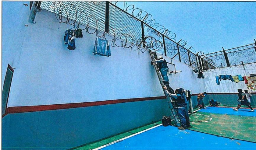
Personal realizando el Escaneo de ACERO en PLACAS – Patio de Pabellón N.º 07
