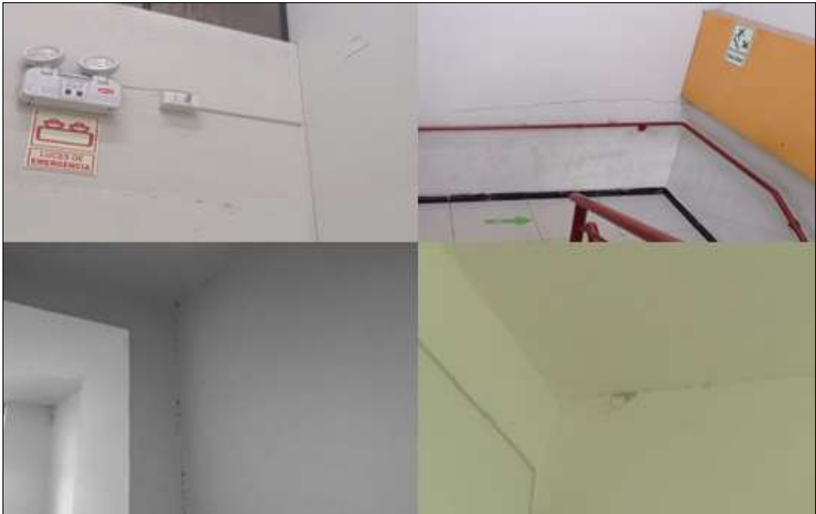
Figura N° 1. Fisuras presentadas en los encuentros entre muros del edificio de 10 pisos más un sótano ubicado en el Jirón Huánuco N° 350, en el distrito de Huancayo.
