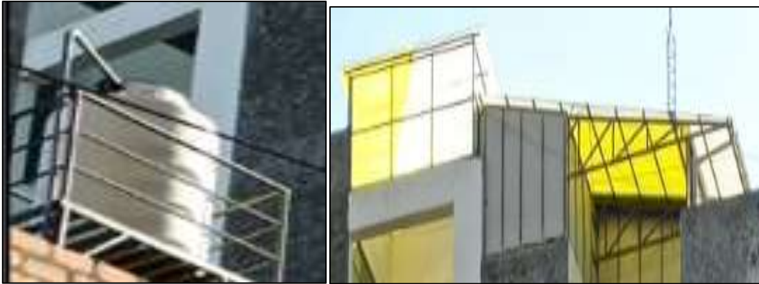
Figura N° 43. Elementos no estructurales mal conectado a la estructura.
