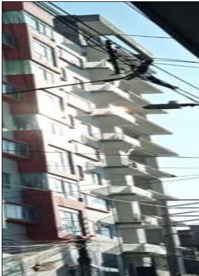
Figura N° 44. Parapetos que se pueden desplomar
