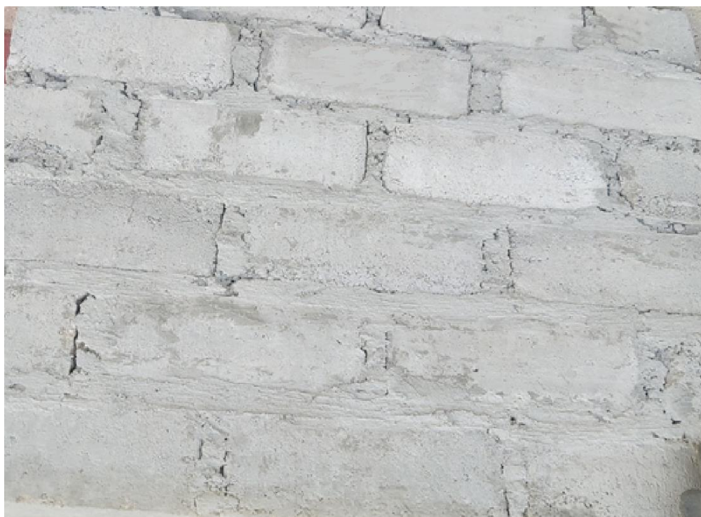
Fotografía 02. Espesores de juntas diversos en muro con ladrillo de concreto
