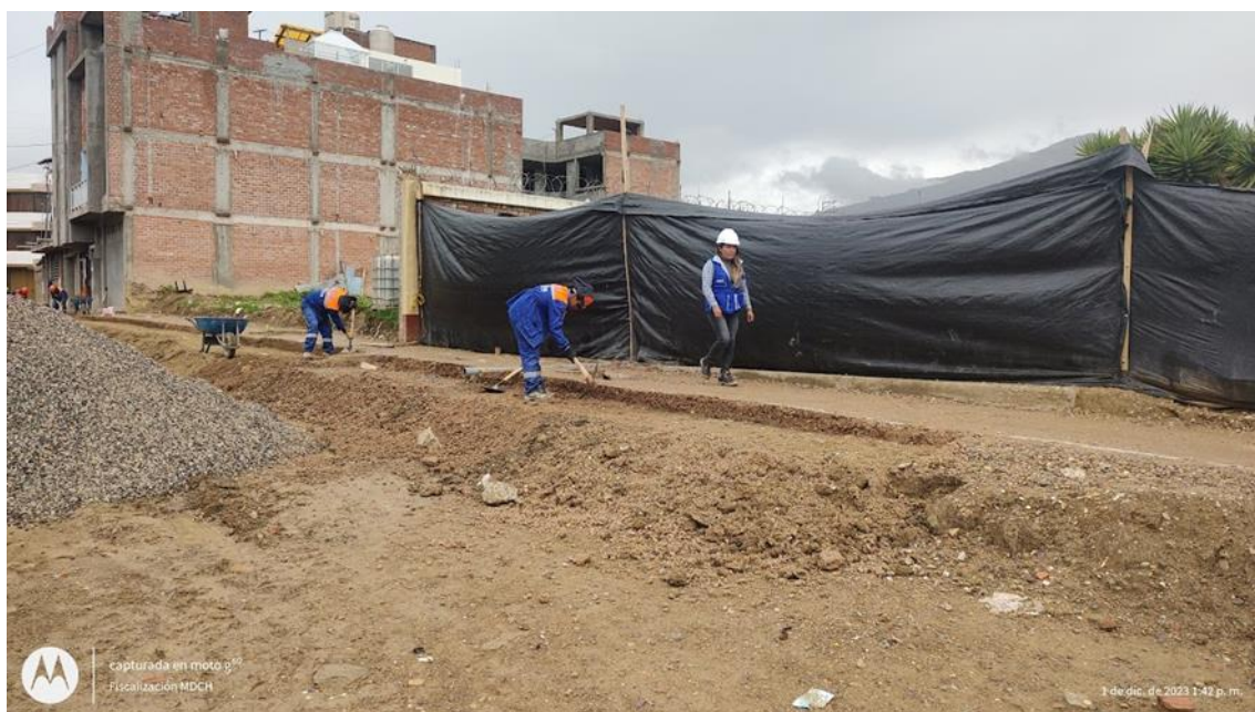
Fotografía 6. Partida Excavación Manual en Terreno Normal, Peones haciendo excavaciones para sardinel de veredas
