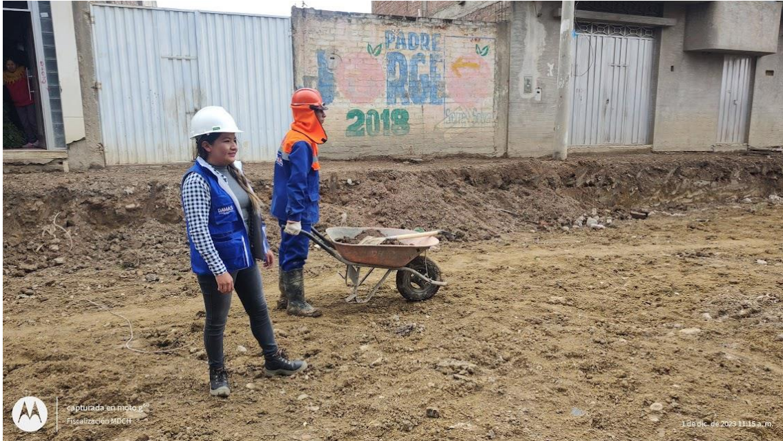
Fotografía 7. Partida Acarreo de Material Excedente, Peón transportando material a una distancia < a 30 m.
