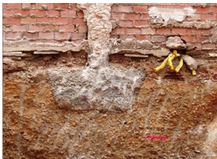
Figura 2 descalce de una cimentación vecina durante la excavación. Fuente: E. Valiente
