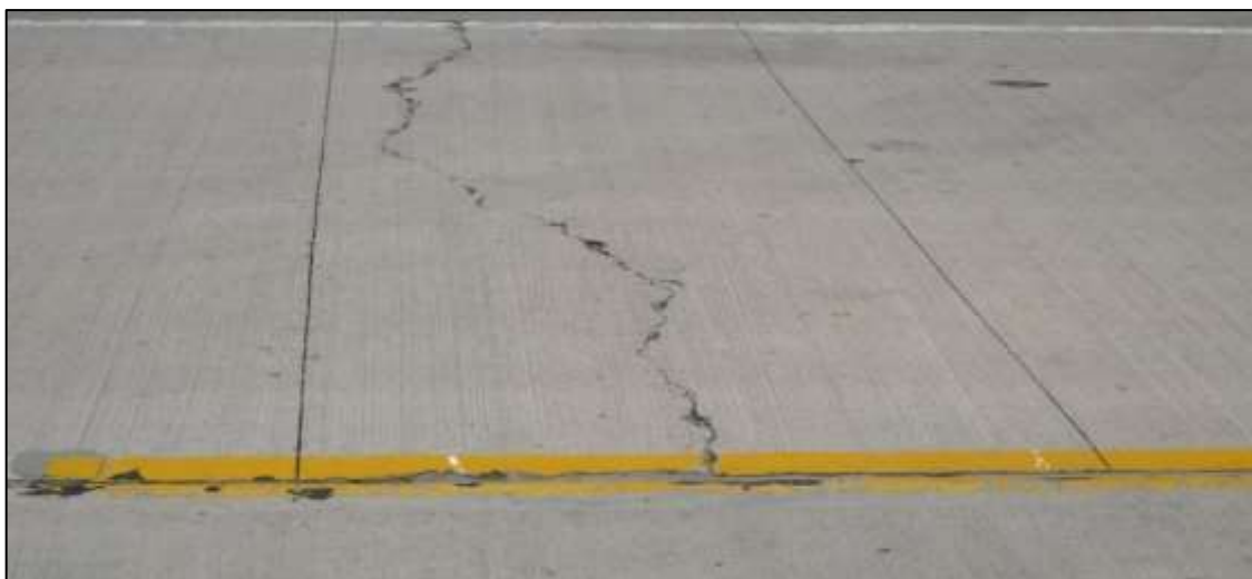
Figura 2. Pavimento con presencia de fisuras.
