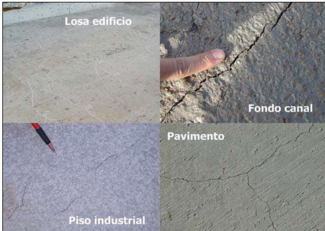
Figura 5. Fisuras por contracción plástica.
