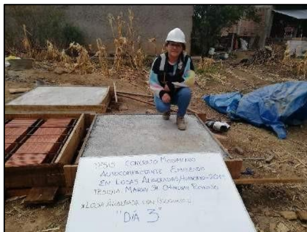
Fotografía N° 55: El curado o fraguado del concreto no debe ser expuesto a goteos o corrientes de agua; según referencia de la NTP 339.183.
