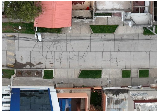
Figura 1.2.Estado actual del pavimento de la Calle San Judas Tadeo.
