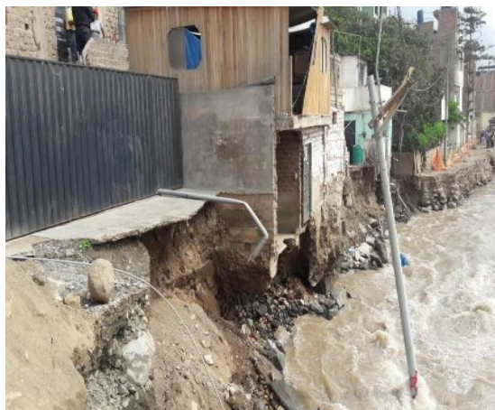
Figura N°04: Erosión carretera central km 35.
