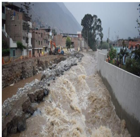
Figura N°05: Erosión de riberas.
