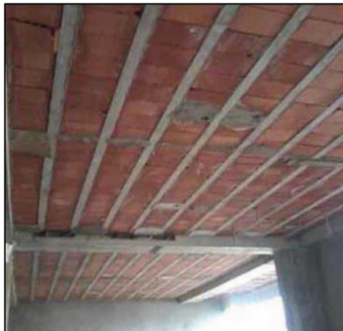
Figura 28. Losa antes planteada. Contiene 10 viguetas pretensadas, 297 bovedillas de arcilla, 0.09 m 3 /m 2 de concreto, 5 vigas soleras y 36 puntales
