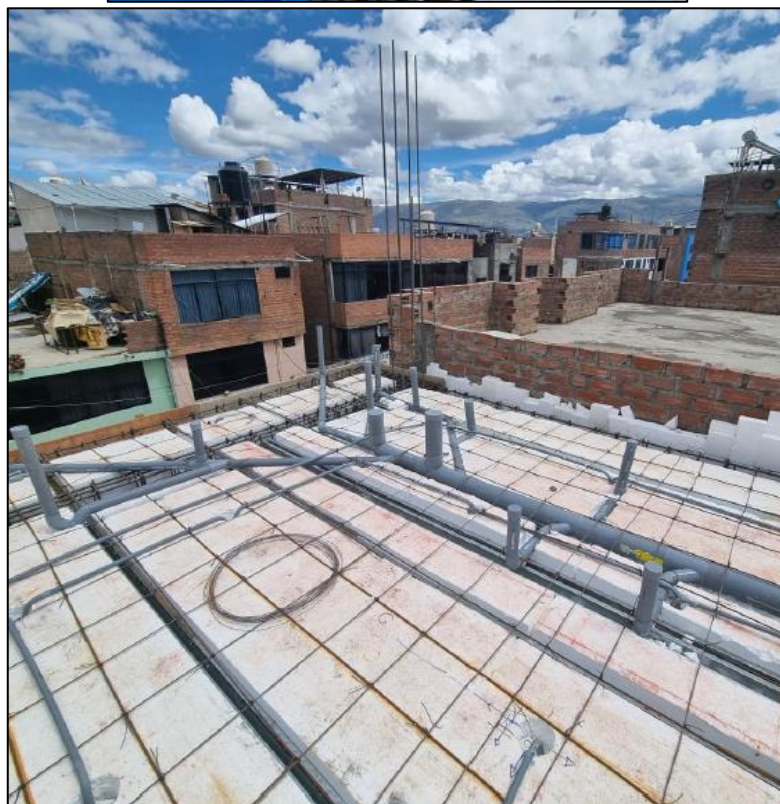
Tuberías de desagüe de baterías de baño
