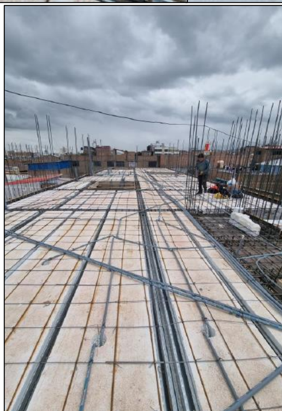
Tuberías de instalaciones eléctricas
