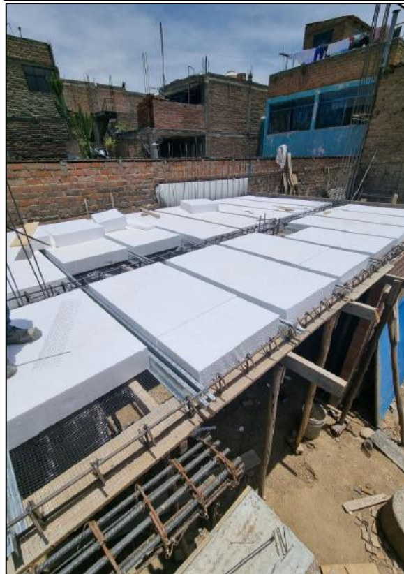
Ubicación y armado de viguetas prefabricadas de acero y casetones de poliestireno
