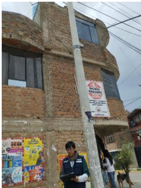
Fotografía 5: Vivienda con desalineación viga columna
