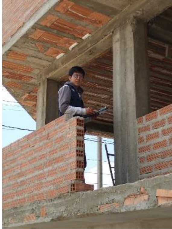
Fotografía 9: Columna corta por muros de mediana altura anclados
