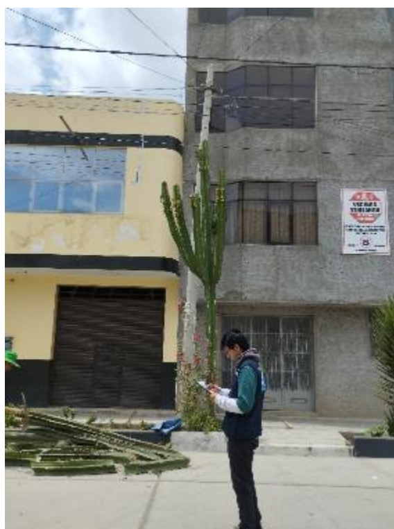
Fotografía 4: Golpeteo entre edificaciones con entresijos desnivelados
