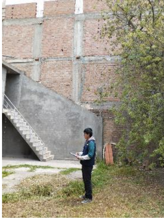
Fotografía 11: Vivienda con parapeto no arriostrado
