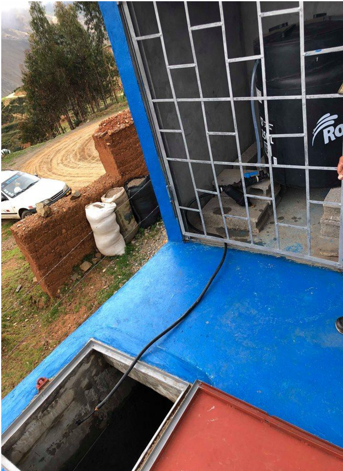
FOTO 11: TERMINO DE LA CONSTRUCCION DE LA CASETA, E INICIAMOS CON EL MONITOREO DE CLORO DE 3 MESES CONSECUTIVOS
