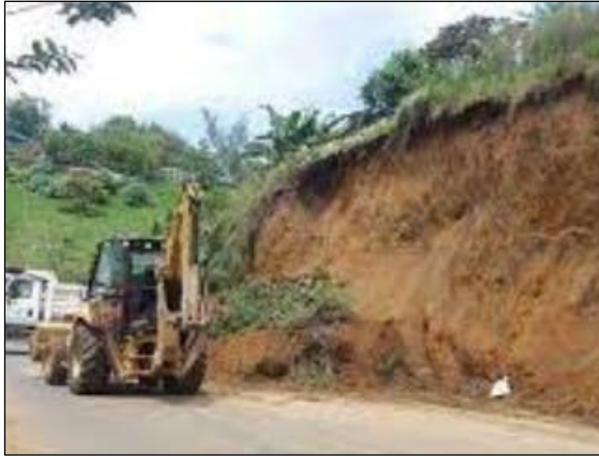
Figura 13: Deslizamiento de talud.
