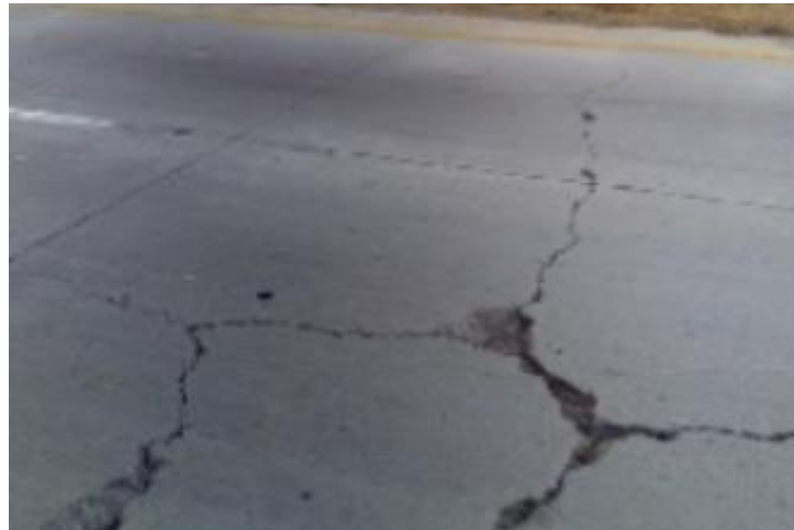
Figura 24. Agrietamiento transversal y longitudinal
