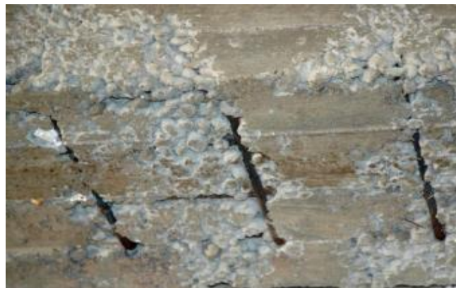
Figura 9. Segregacion del hormigón
