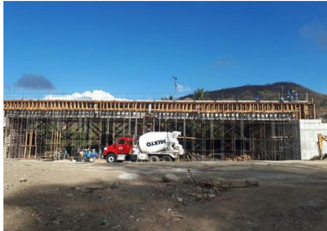
Figura 12. Desempeño del concreto
