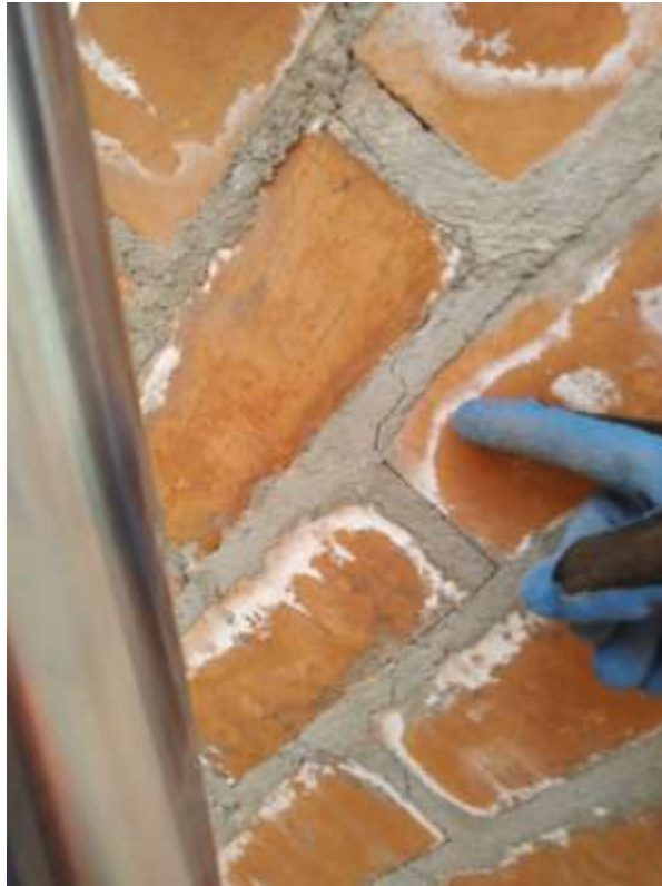
Fotografía 43. Nótese la fractura diagonal en el murete.
