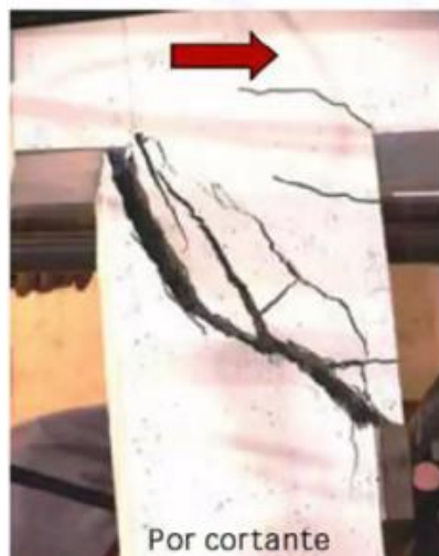
Figura 9 Falla de columna por efecto de cortante y torsión producida por excentricidad de la viga longitudinal
