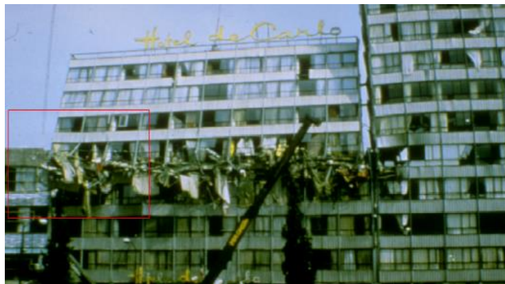
Figura 11 Falla debido a golpeo entre edificios adyacentes
