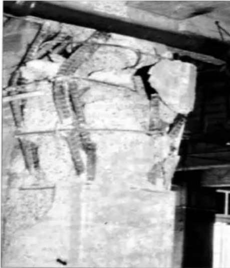
Figura 5 Falla de columna con escaso refuerzo transversal
