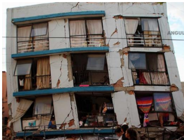
Figura 13 Daños en elementos de fachada por movimientos laterales excesivos del edificio
