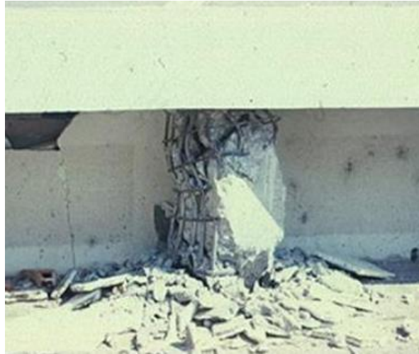
Figura 12 Falla por cortante en columna corta.
