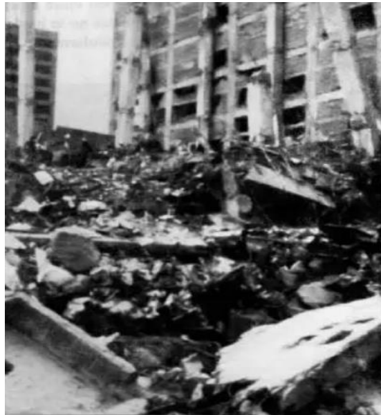
Figura 7 Falla de un edificio a base de losas planas por punzonamiento de losa
