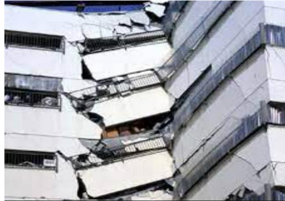
Figura 10 Daño en edificio por vibración torsional
