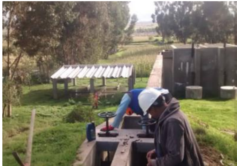
Figura N° 3: Limpieza del PTAR de San Jerónimo. Nota: Municipio distrital de San Jerónimo. (2019)
