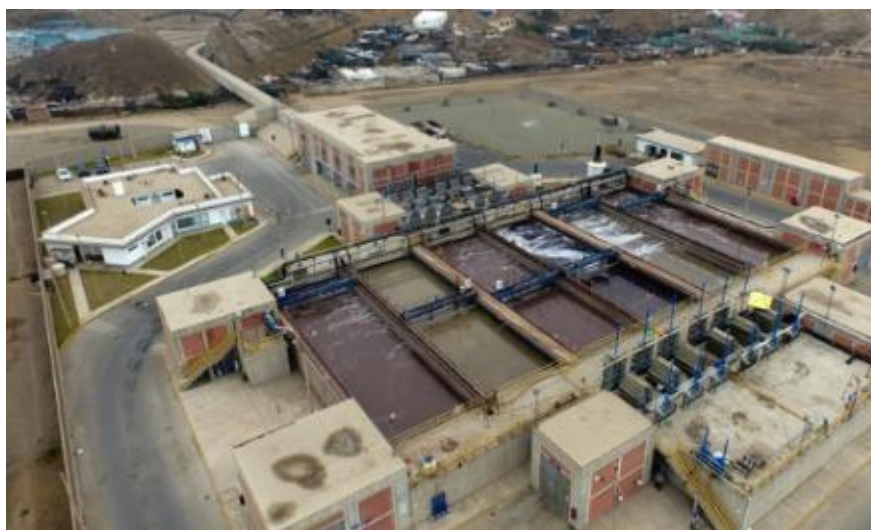
Figura N° 8: Plantas de tratamiento de aguas residuales.
