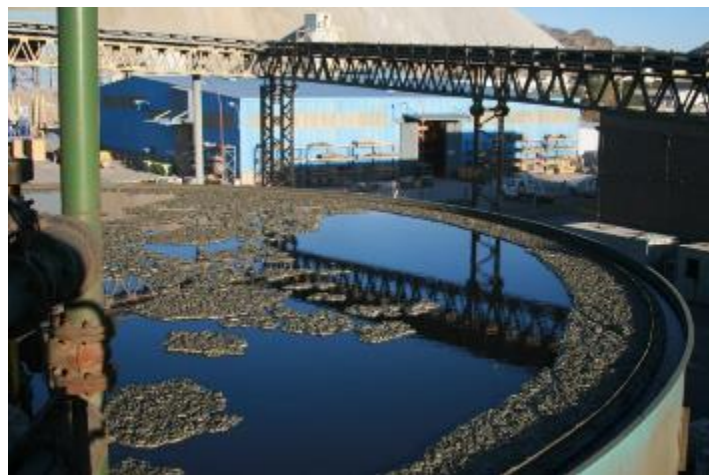
Figura N° 19: Características de aguas residuales.
