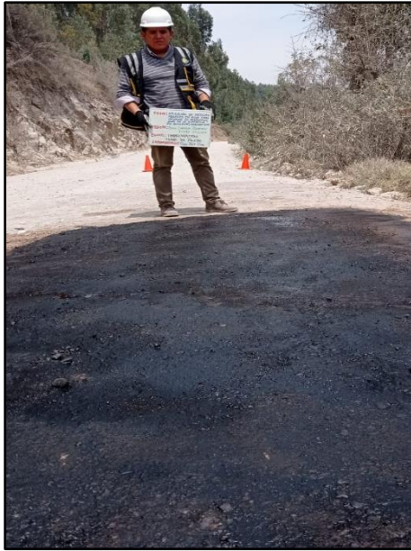
Fotografía N° 31: Imprimación de capa de rodadura de tramo de prueba según la referencia de la Manual MTC - EG2013.
