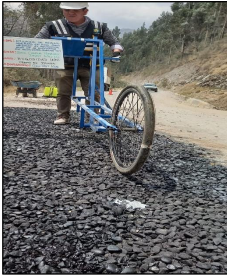
Fotografía N° 33: Determinación de la medición del rugosímetro por el método Merlín (IRI), según la norma (ASTM E 1926).
