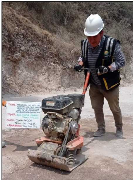
Fotografía N° 30: Compactación de capa de rodadura de tramo de prueba según la referencia de la Manual MTC - EG2013.
