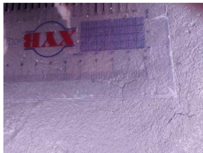
Fotografía 21. Vista de la medición de las fisuras en el concreto.
