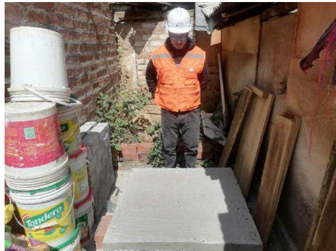
Fotografía 18. Vista del concreto desencofrado, listo para la medición de las fisuras.
