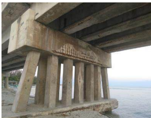
Figura 2.10. Segregación del concreto. Fuente: IMCYC (1979).
