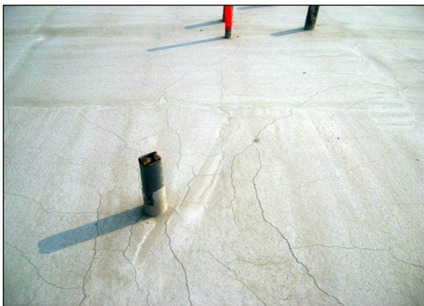
Figura 1.1. Losa aligerada con presencia de fisuras en su superficie. Fuente: García (2012).
