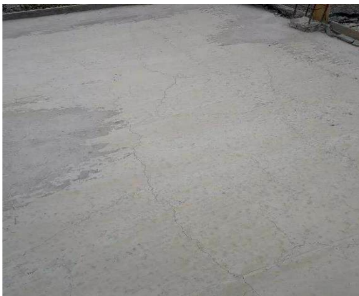
Figura 1.2. Fisuras producto de la contracción plástica. Fuente: García (2012).
