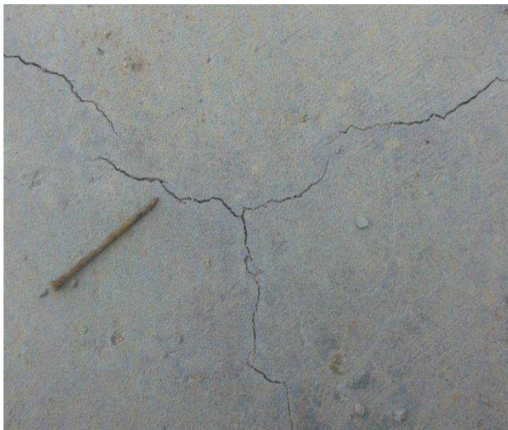
Figura 2.7. Fisuras por contracción plástica. Fuente: IMCYC (1979).
