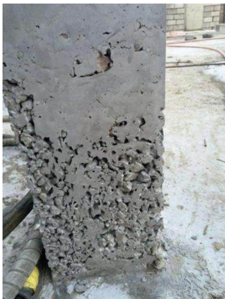
Figura 2.9. Segregación del concreto. Fuente: IMCYC (1979).
