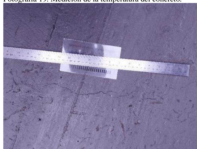
Fotografía 20. Cálculo de las fisuras del concreto durante la contracción plástica.
