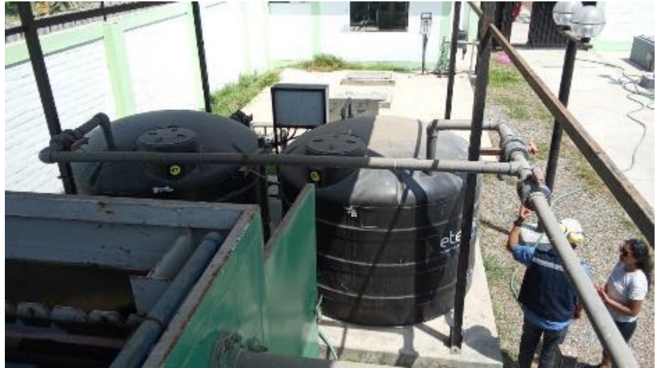
Figura 11. Tanque de filtración
