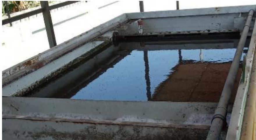
Figura 10. Filtración del agua
