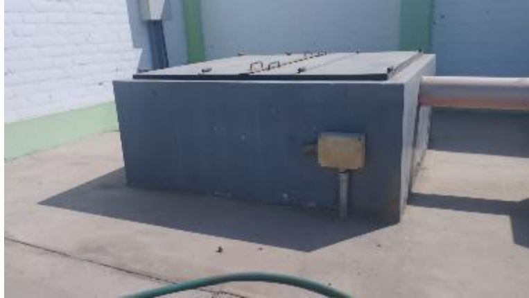
Figura 5. Cámara de bombeo
