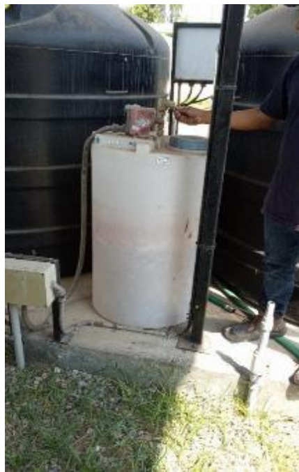
Figura 12. Tanque de cloro
