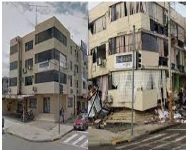
Figura 1: Edificios con fallas.
