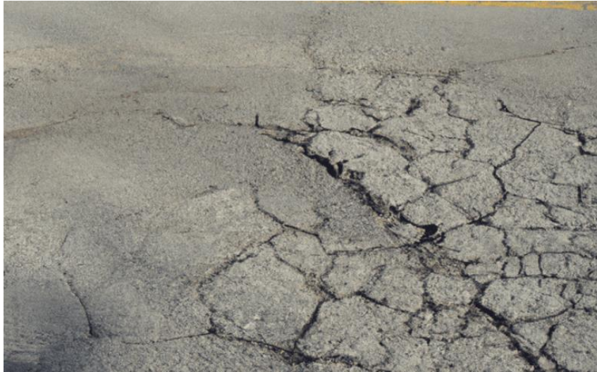
Figura 1. Fallas comunes en los pavimentos flexibles
