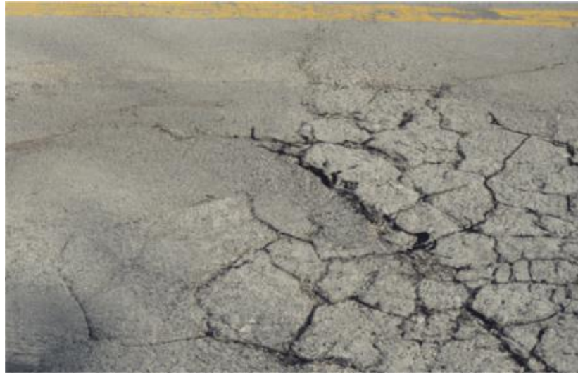
Figura 7. Fisuras y grietas por fatigamiento
