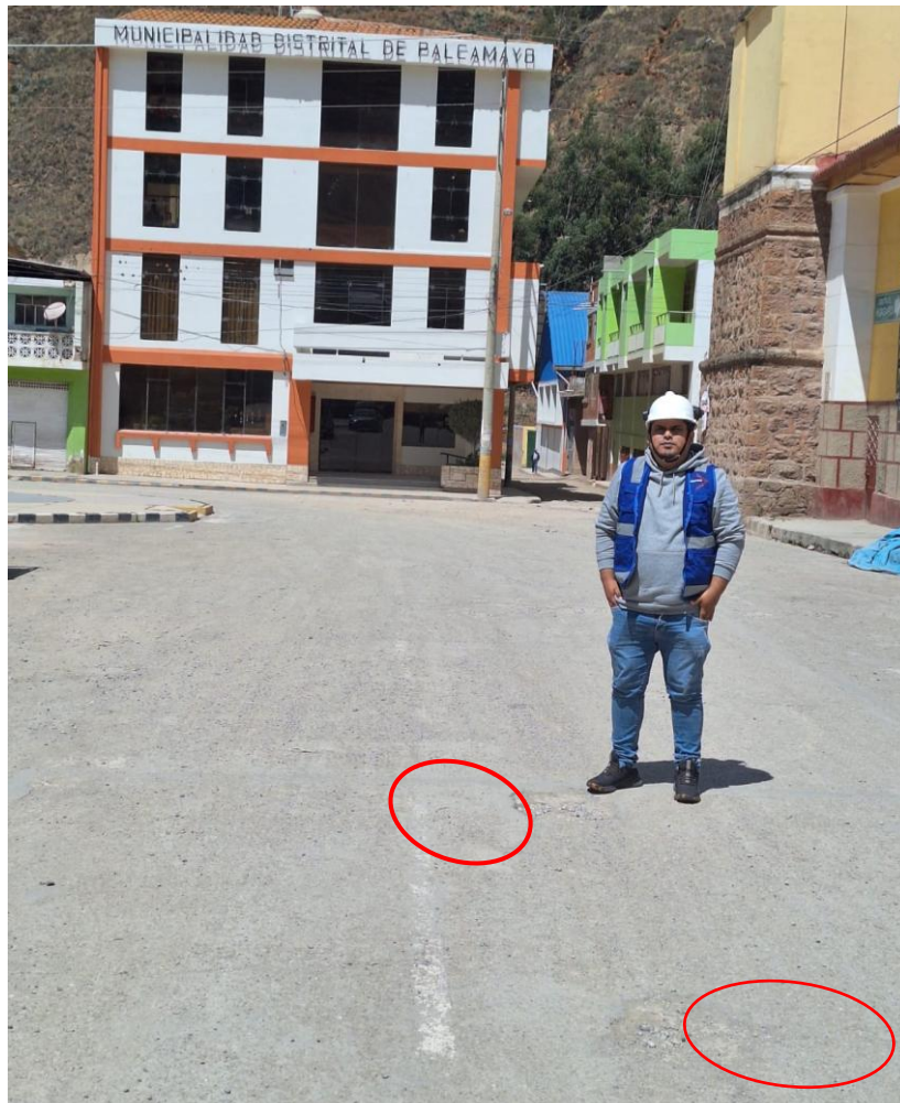
Fotografía 4: Carretera Acobamba - Palcamayo. Inicio de Tramo Daño en Capa Asfáltica
