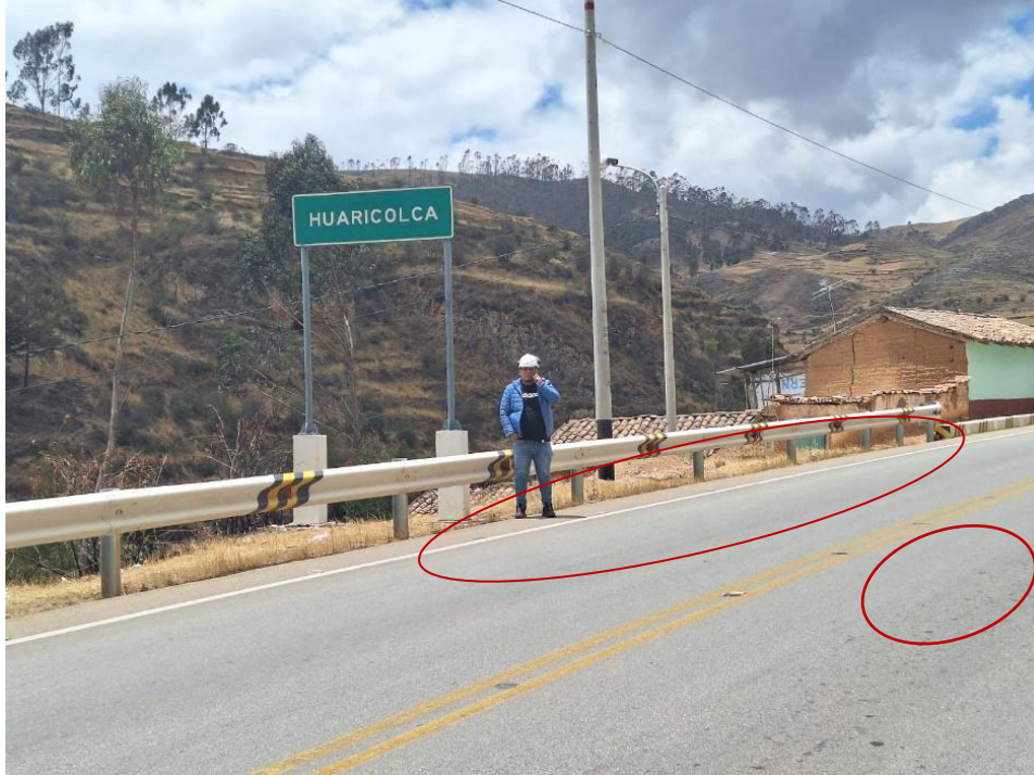
Fotografía 15: Carretera Tarmatambo – Huaricolca daño de Capa Asfáltica Final de Tramo.
