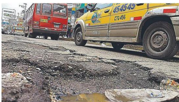
Figura 15. Baches en pavimento.
