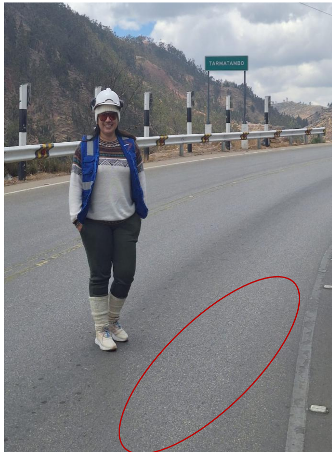
Fotografía 12: Carretera Tarmatambo – Huaricolca daño de Capa Asfáltica Inicio de Tramo.
