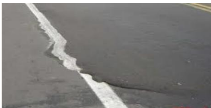
Figura 13. Ondulaciones en pavimento.
