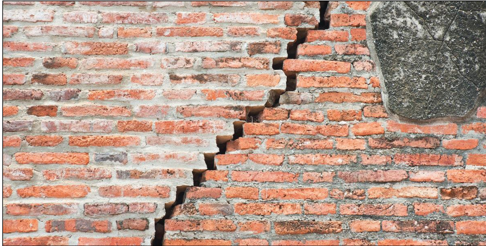
Figura 1: Fallas en juntas de muro de albañilería con ladrillos. Tomado de https://www.solerpalau.com/es-es/blog/patologias-edificaciones/
